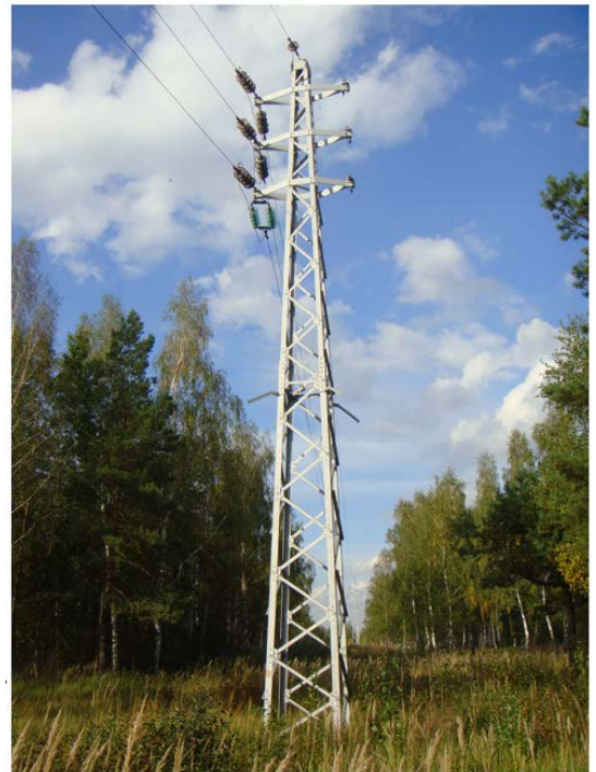
Рис. 5.2: анкерная опора C-15
