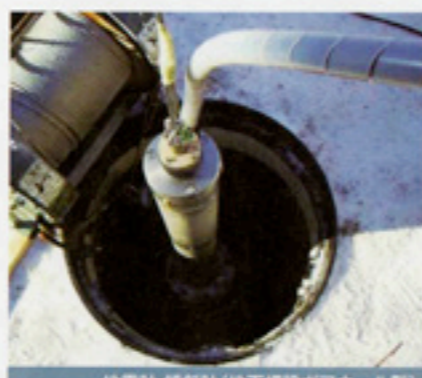
地震計・傾斜計(地下埋設ボアホール型)
