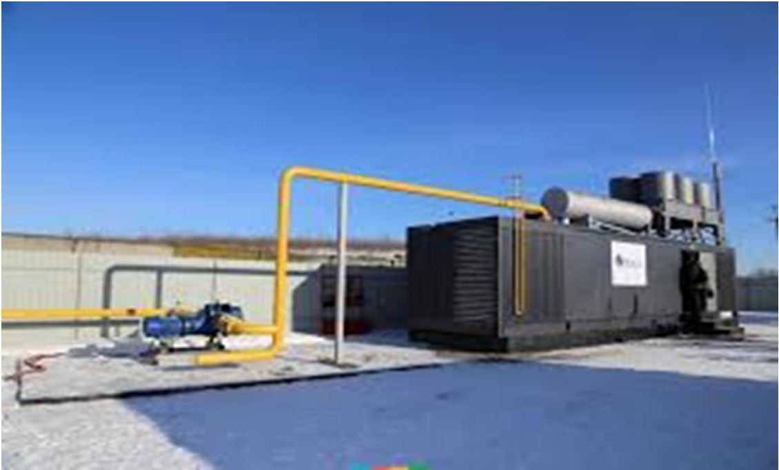
Когенераційна установка з дегазації полігону твердих побутових відходів у м. Хмельницькому
