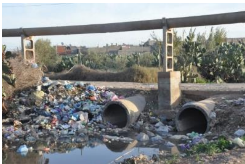
Photo 12 : Rejets d'eaux usées à l'air libre au niveau de Douar Zembrane situé dans la ceinture verte Source: AHT-RESING
