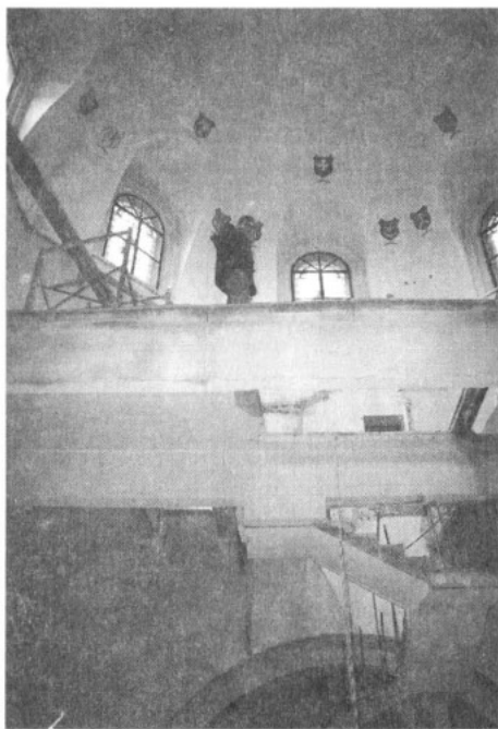
Залишки залізобетонних стропів у церкві, березень 1997 року.
