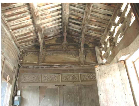
照片 3- 21 前廳桁木有蛀蝕龜裂現象
