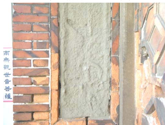
照片 3- 61 第一落前檐牆石雕風化嚴重
