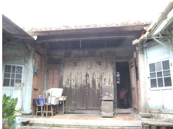
照片 3- 6 木作隔斷牆有腐朽情形
