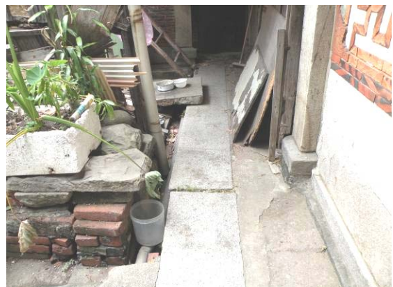
照片 3- 2 排水溝附近堆積諸多雜物
