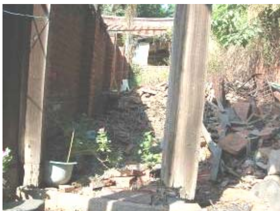
照片 3- 19 大廳已坍塌
