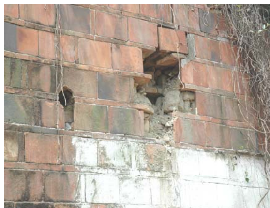
照片 3- 30 斗子砌牆有缺損情形，且滋生雜草
