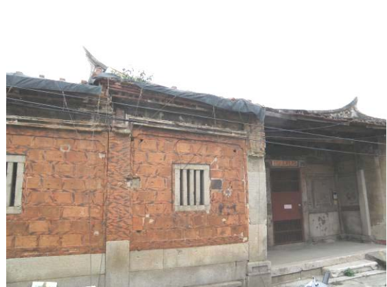
照片 3- 18 斗子砌外牆嚴重龜裂
