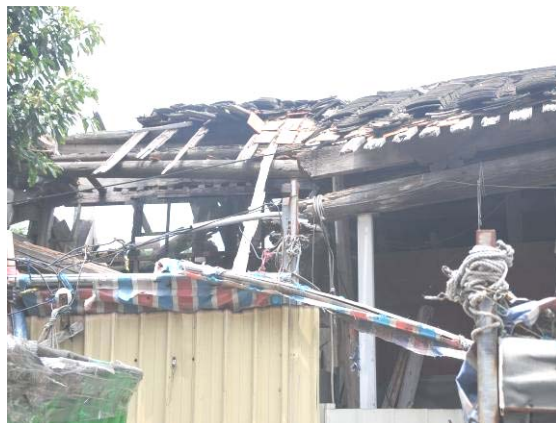
照片 3- 26 屋嚴重頂坍塌，導致諸多廢材與雜物堆積於入口處
