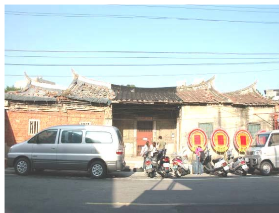
照片 3- 14 前廳屋面嚴重破損
