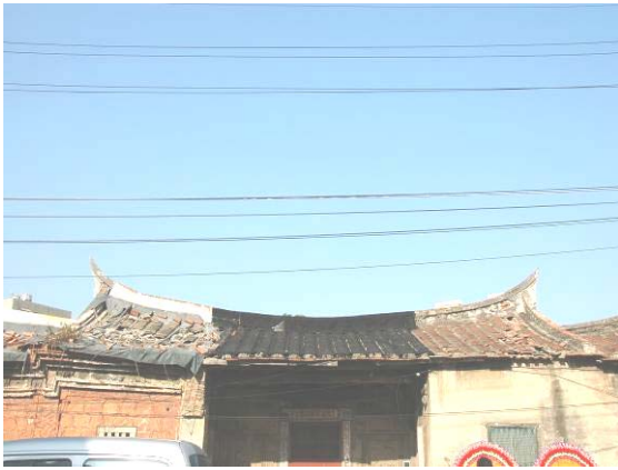
照片 3- 23 前廳屋瓦脫落，現暫以防水布遮蔽
