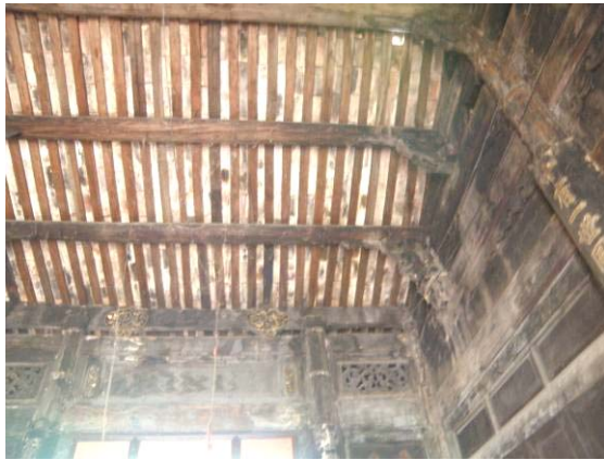
照片 3- 7 前廳桁木有腐朽現象
