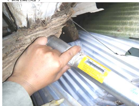
照片 3- 46 檐口構件腐朽嚴重
