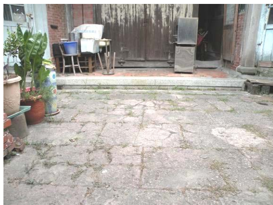
照片 3- 4 尺磚有缺損、破裂現象
