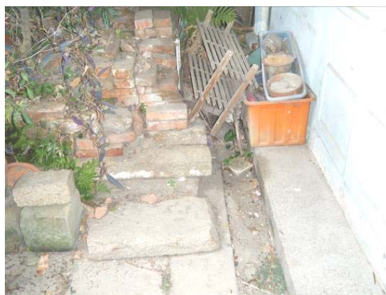
照片 3- 34 排水溝遭堆置雜物並淤積泥沙
