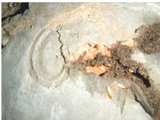
照片 3- 43 第一落瓜柱構件發現大量白蟻活體
