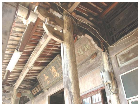
照片 3- 20 後落廳檐廊現有坍塌情形
