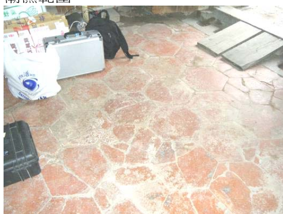
照片 3- 58 第一落明間地坪潮濕
