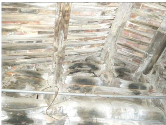
照片 3- 48 第一落門廳構件有面狀水漬
