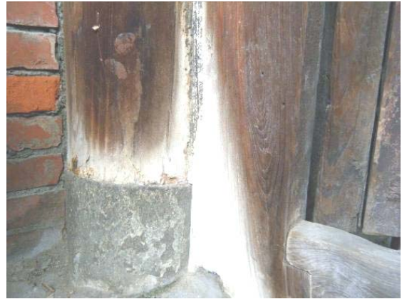
照片 3- 40 木柱底部之石材沉澱
