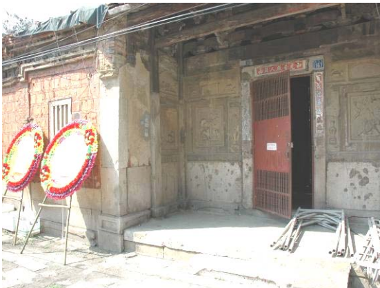
照片 3- 17 前廳花崗石牆面粉刷剝落嚴重
