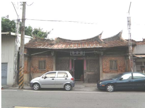
照片 3- 1 進士第部分屋頂有坍塌情形
