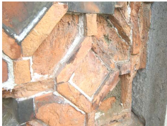
照片 3- 35 第一落外側之磚牆嚴重風化
