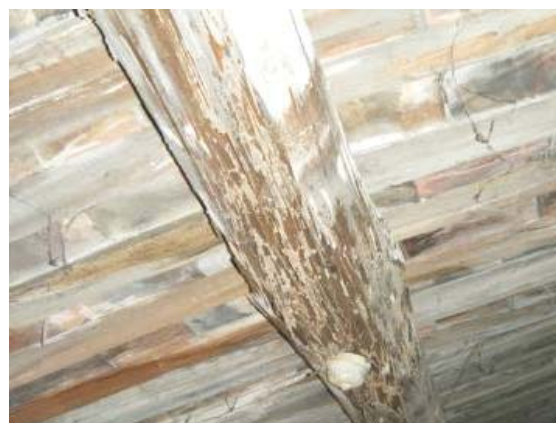
照片 3- 38 中脊遭白蟻蛀蝕致破損斷裂
