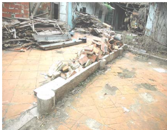
照片 3- 28 大廳地坪局部破損
