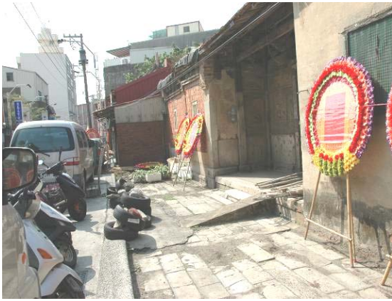
照片 3- 15 花崗石條鋪面，有風化與龜裂現象
