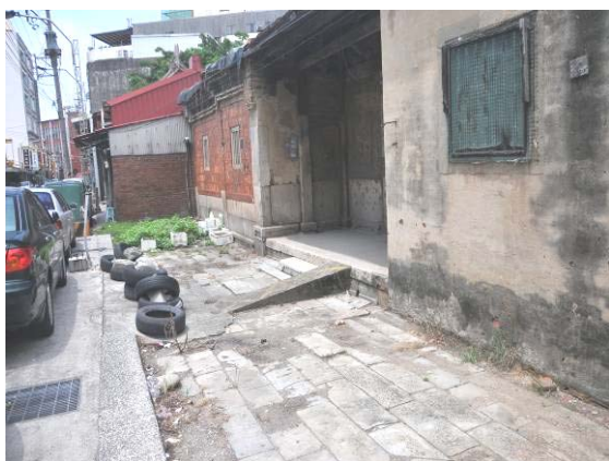
照片 3- 13 外埕高程較道路低，且排水溝有部分堵塞情形
