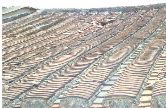
照片 3- 53 第二落屋瓦破損
