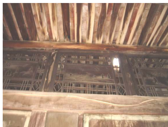
照片 3- 22 後落廳神龕桁木受屋面滲水影響導致腐損
