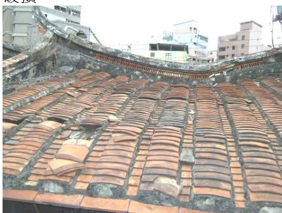
照片 3- 54 第一落屋頂遭植物附生及屋頂塌陷
