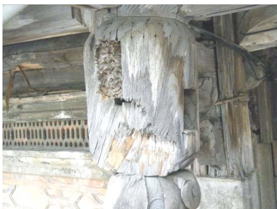
照片 3- 37 開裂及白蟻蛀蝕共同危害
