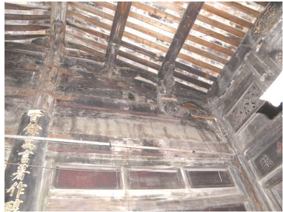
照片 3- 8 大廳桁木有腐朽現象
