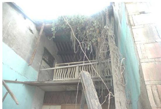
照片 2- 78 盡間屋面毀損
