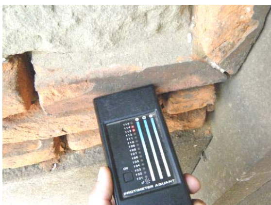
照片 3- 56 第一落前檐牆讀數 114，屬潮濕範圍
