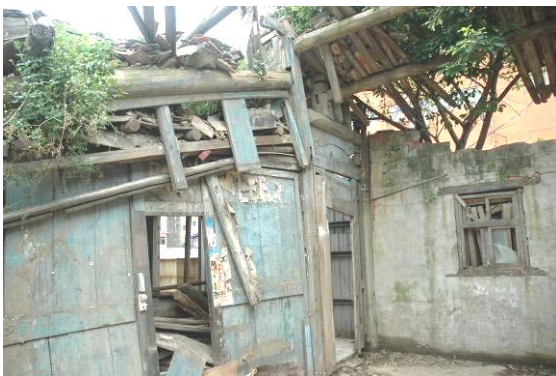
照片 2- 73 屋面塌陷
