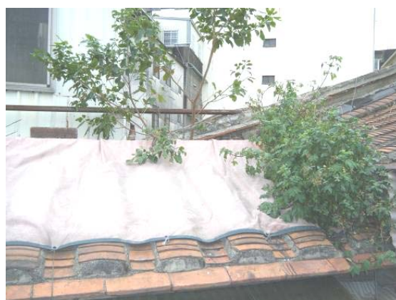
照片 3- 55 右櫺頭屋頂遭植物附生
