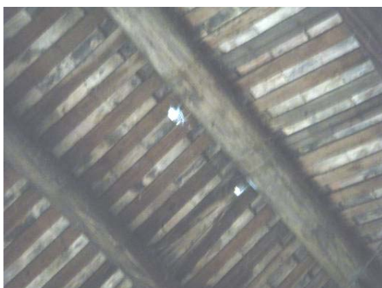
照片 3- 52 第二落神明廳中脊旁望磚破損
