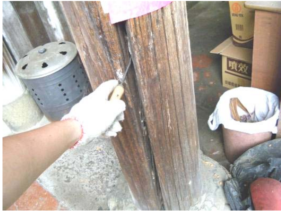
照片 3- 39 檐柱全根縱向割裂嚴重
