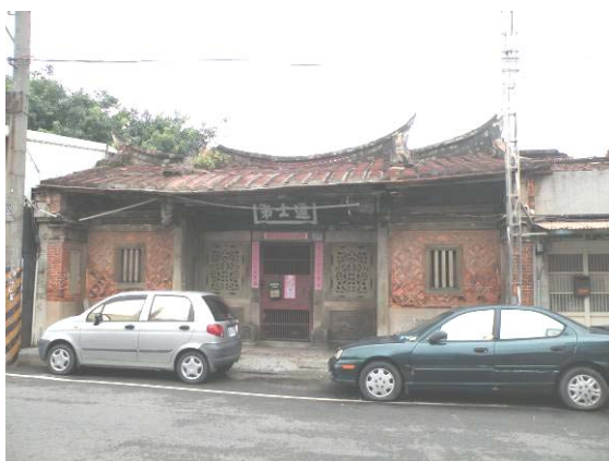
照片 3- 11 前廳屋面破損嚴重
