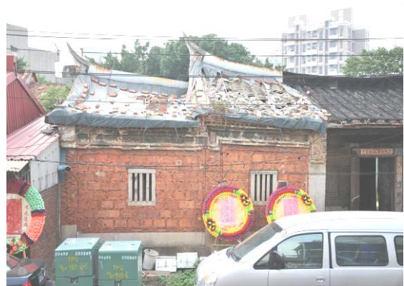
照片 2- 54 右側屋脊損壞嚴重，現暫以鐵板固定
