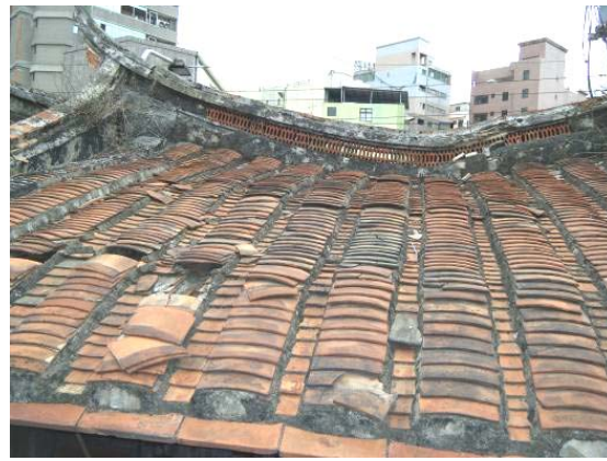
照片 3- 36 第一落屋頂遭植栽附生，屋面破損
