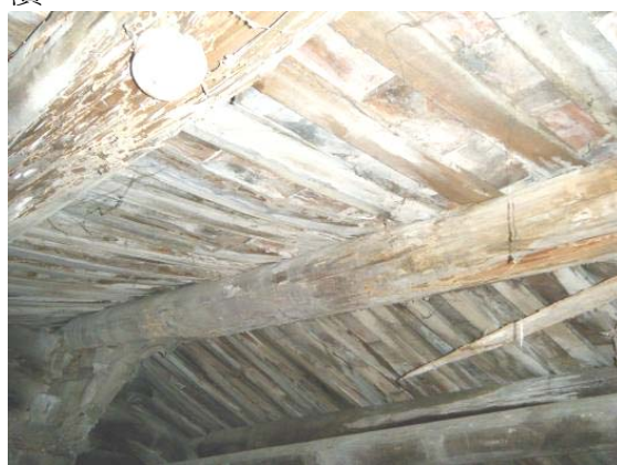
照片 3- 50 第一落明間屋桁遭白蟻蛀蝕，引發屋頂大幅度下陷
