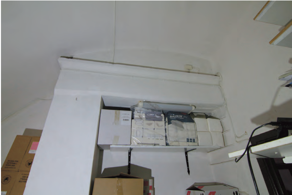
Östra rummets äldre spis som går från golv till tak och är mycket stor. Spisomfattningen är kopplad till den idag igensatta skorstenen. Väggen till höger tillkom på 1970-tal när rummet delades upp i två delar mitt i spisen som idag syns i två olika rum.
