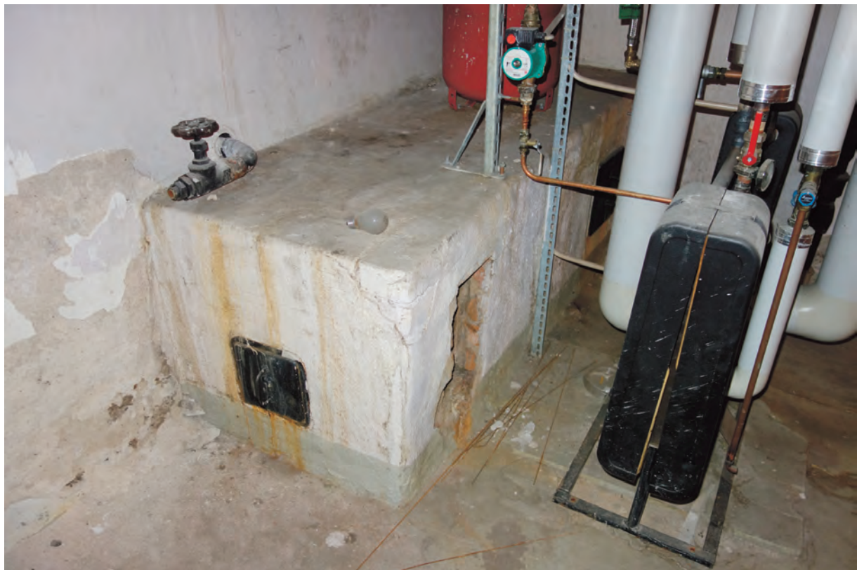
Den äldre kolpannan har bytts mot modernare installationer, men den äldre sockeln, mässingsarmatur och sotlucka av järn finns bevarade.
