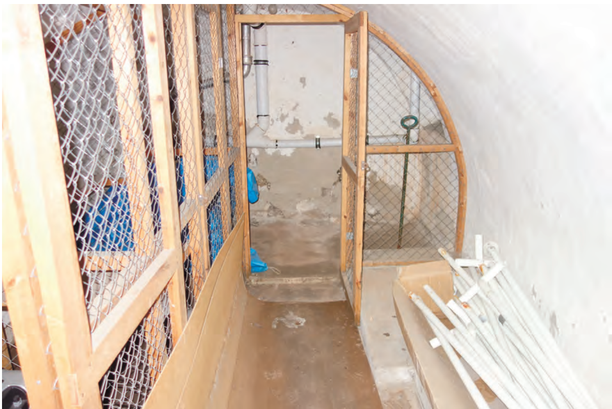
Den gamla källarens välvda tak och väggar går ibop. Rummet är idag inrett med förråd av trä och hönsnät.
