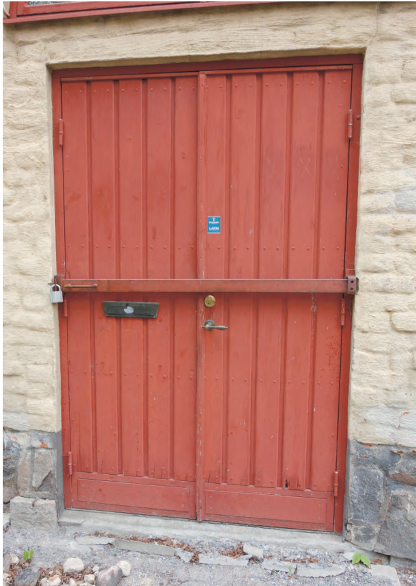
Entréddörr mot väst. Även denna bytt på 1970-tal och utsmyckad med dekorspik.
