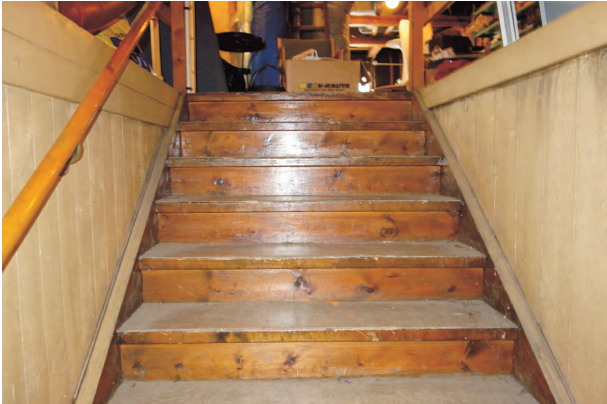
Trappa till vindsvåningen. Uppförd av gran med enkla steg, belagda med linoleummatta. Trappan nyuppfördes 1932.
