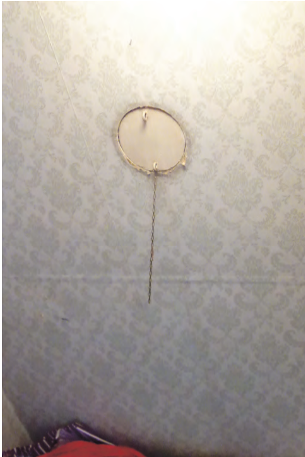
Ventil med vipplocka i kattvind, finns i samtliga fyra kattvindar.
