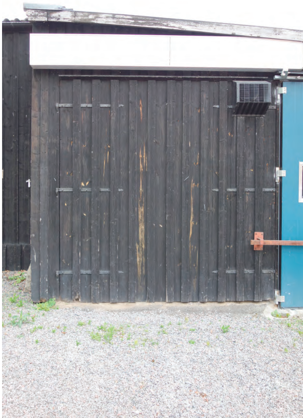
Byggnadens igensatta port med bandgångjärn, av allt att döma från ombyggnationen 1971 och senare igensatt.
