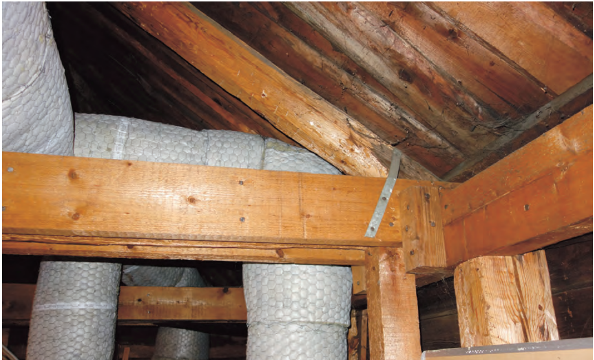
Komplettering av takstolar, troligen från 1930-tal. Stora, ramsågade regler har installerats för att komplettera stockar av angräpet virke.
