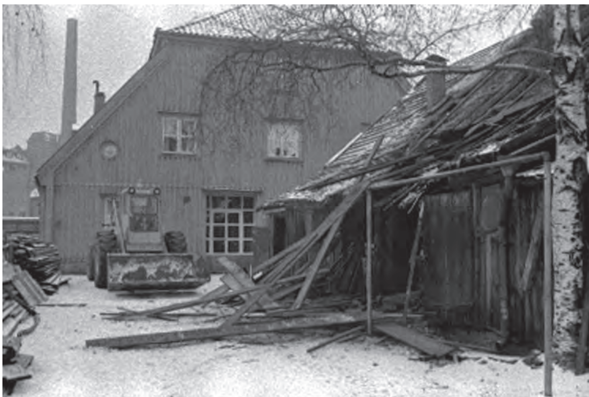
Foto från rivningstillfället då resterande bebyggelse på Bergsbron 7 togs ned 1967. Foto från Norrköpings stadsmuseum.
