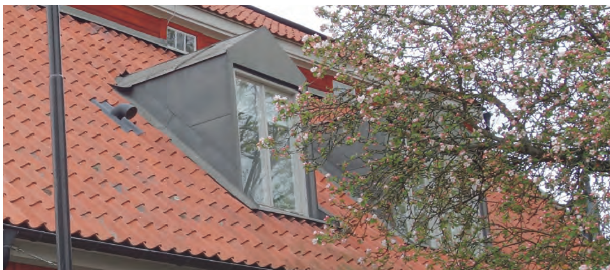
Exempel på byggnadens avluftning mot söder. Varje kattvind har en liknande rödrugning med en stängningsventil invändigt, troligen från 1930-tal.
