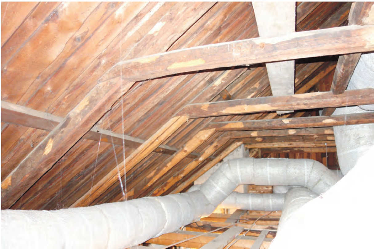
Byggnadens takstolar, fläckvis renbuggna och provbuggna för ohyra. Över bindbjälkarna täcks vinden till stor del av rördragningar till ventilationsanläggningen.
