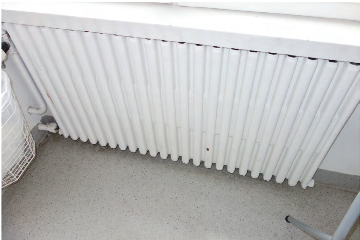
Elementinstallationer finns bevarade i stora delar av byggnaden, dessa är troligen från 1900-talets mitt.
