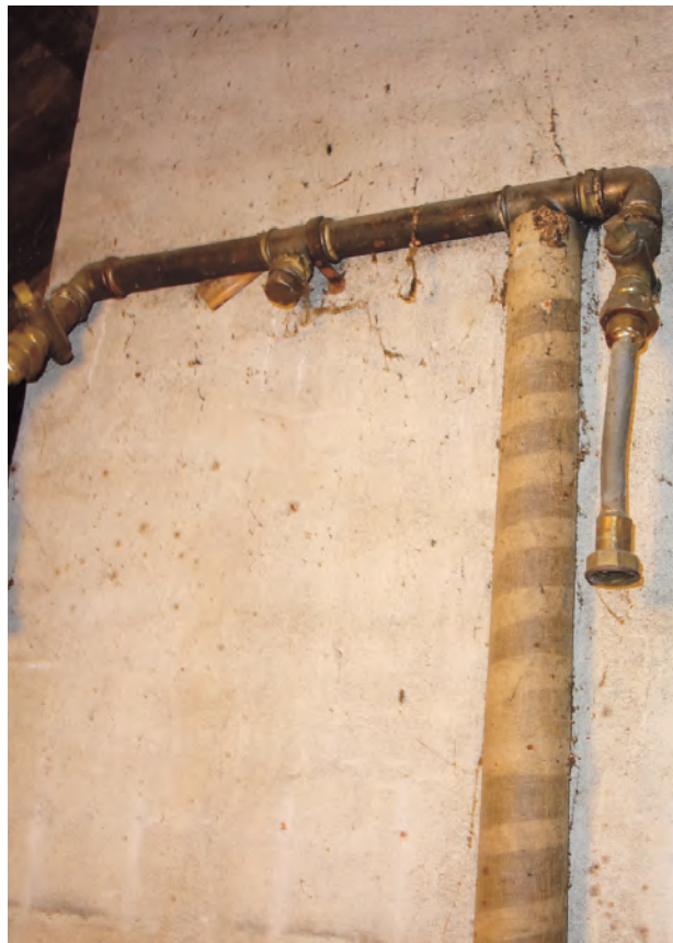
VVS-installation från 1930-talets ombyggnation, troligen har detta varit kopplat till ett expansionskärl.
