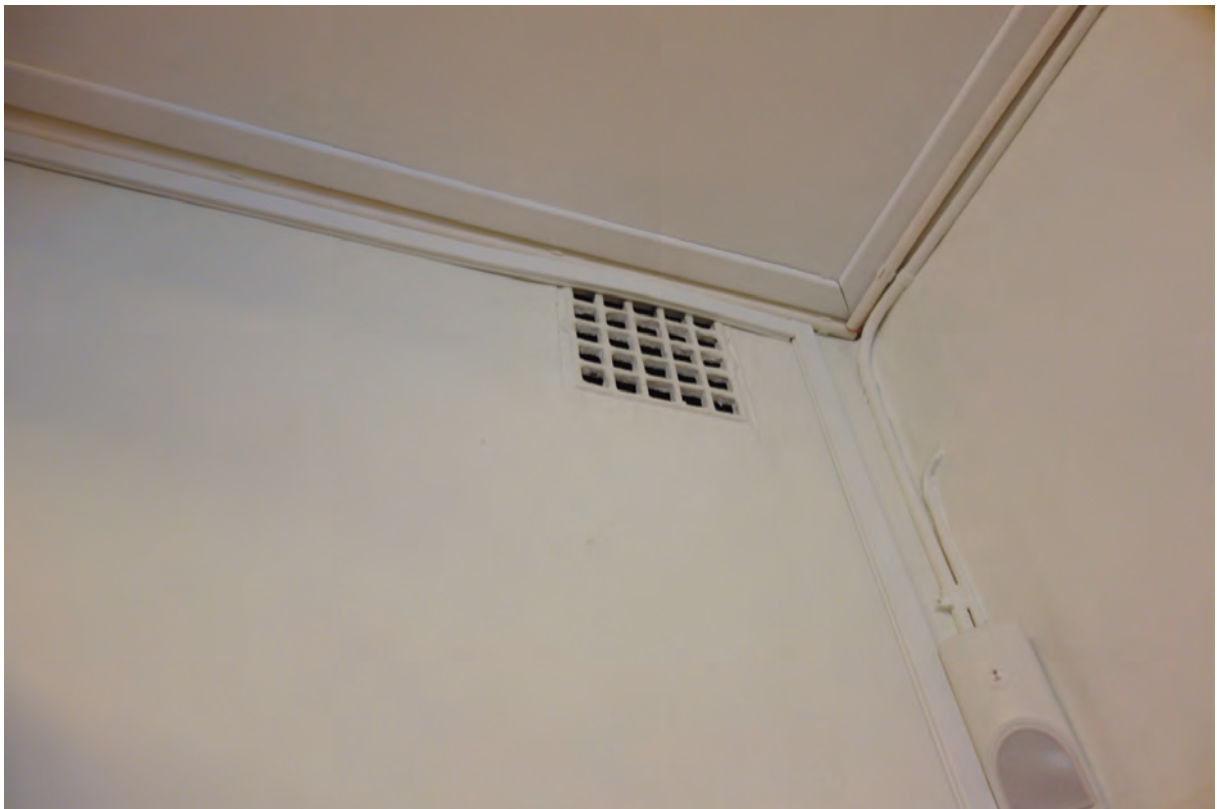
Frånluftsgaller från 1930-talets renovering finns bevarade på flera platser i byggnaden. Ibland jämsides nyare frånluft.
