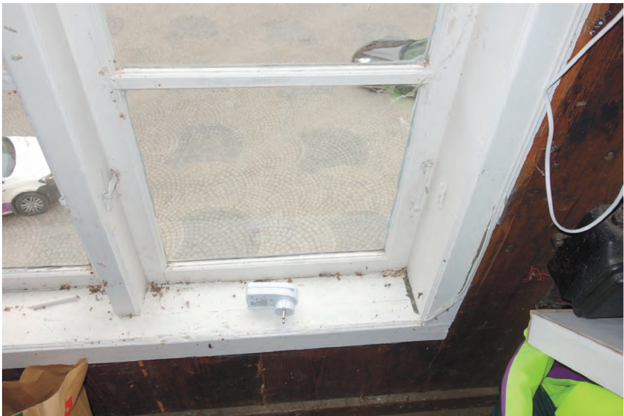
Fönster i gavel mot väst. Enkelglas med äldre smidda beslag. Fönstret är ett av byggnadens äldsta.
