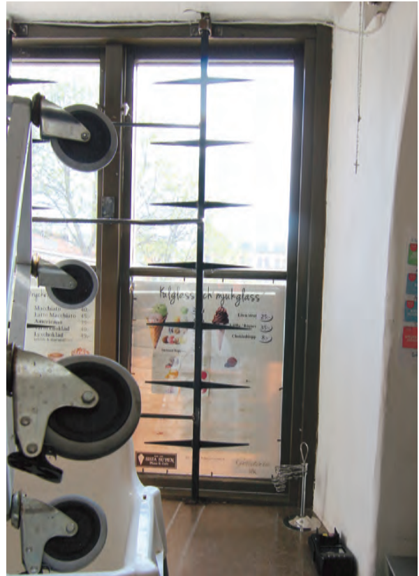
Fönsternischer är djupa och vitputsade med galler fastmonterade i fönsterkarmar. Galler har en historicerande utformning som troligen är en kopia på galler som tidigare funnits.
