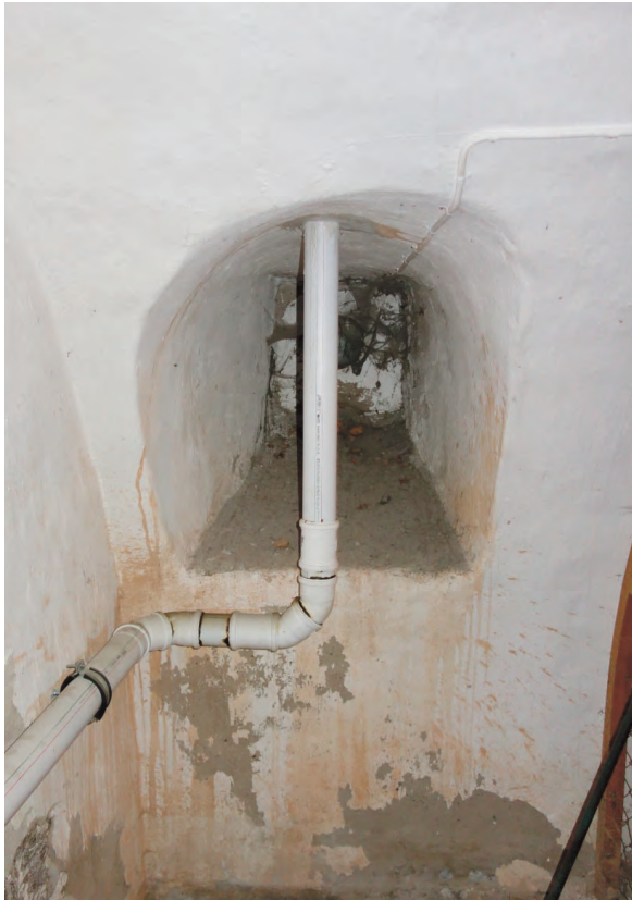
Äldre öppning i källaren är idag igensatt. En rördragning har gjorts nyligen till det nyrenoverade badrummet ovanför.
