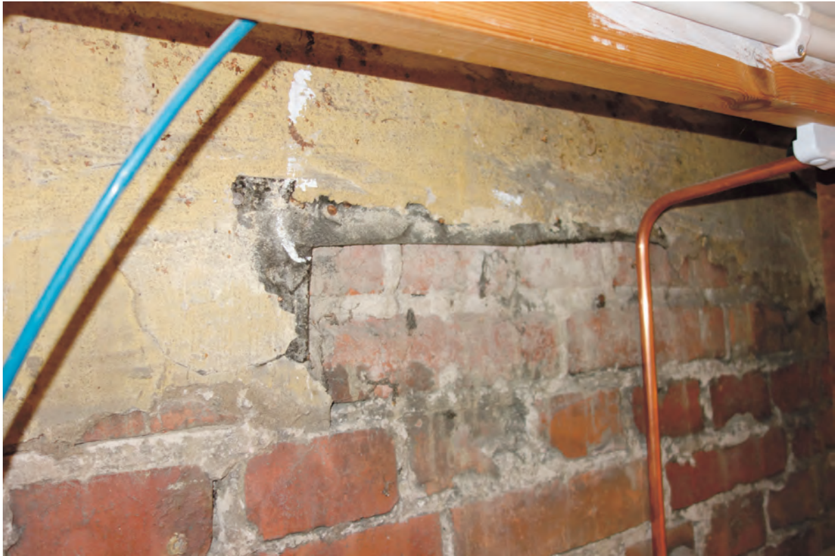
Övergång mellan puts och oputsad tegelfasad där tidigare bodbyggnader stått. En smal våd av tjärimpregnerad papp finns kvar där taket tidigare mötte väggen. Denna vägg har inte åtgärdats vid ombyggnation 1971, och ej heller därefter vilket möjliggör att se äldre byggnadsplacering.
