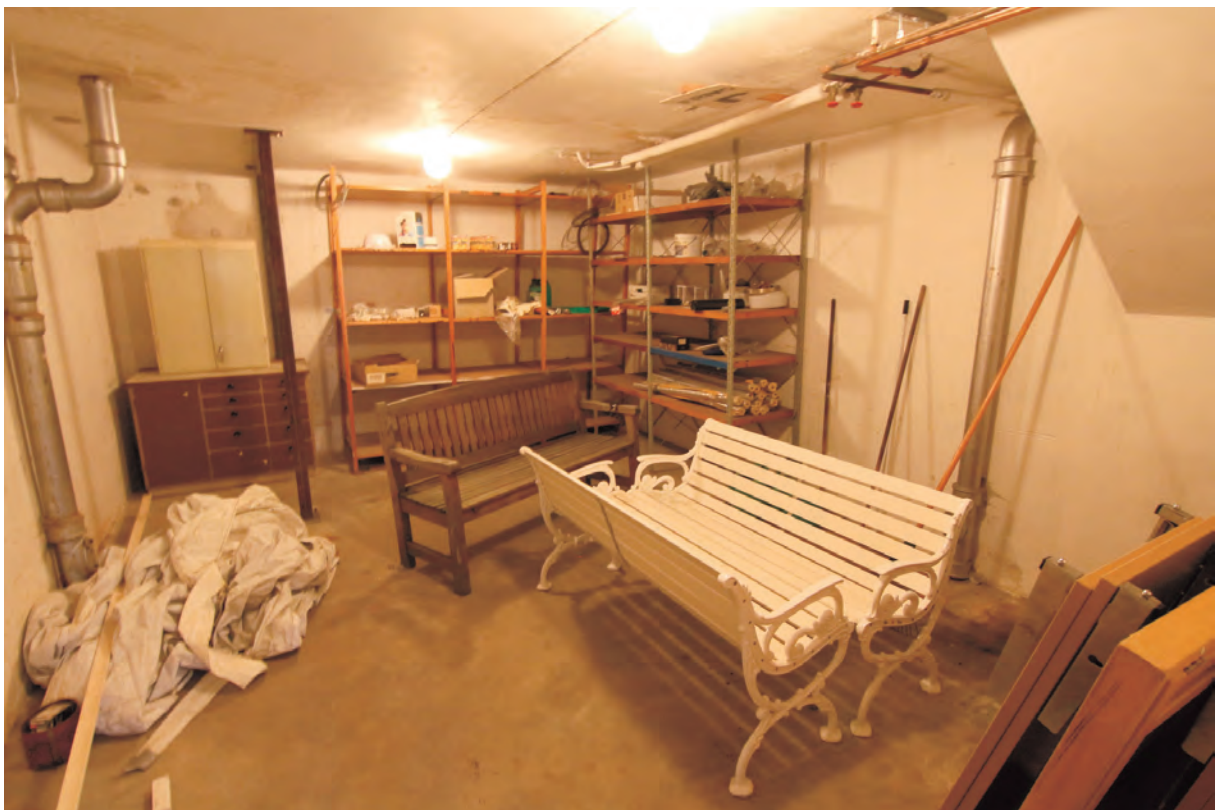
Källarens stora förvaringsutrymme. En blandning av installationer från olika tider finns. Avloppsror av gjutjärn på båda sidor av rummet är troligen från 1930-talet.
