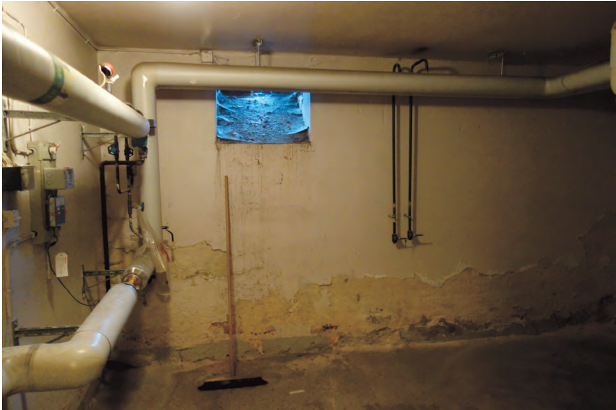
Källarens panncentral med en bevarade kolstört från 1932. Här lastades kocks in för förbränning i pannrummet.
