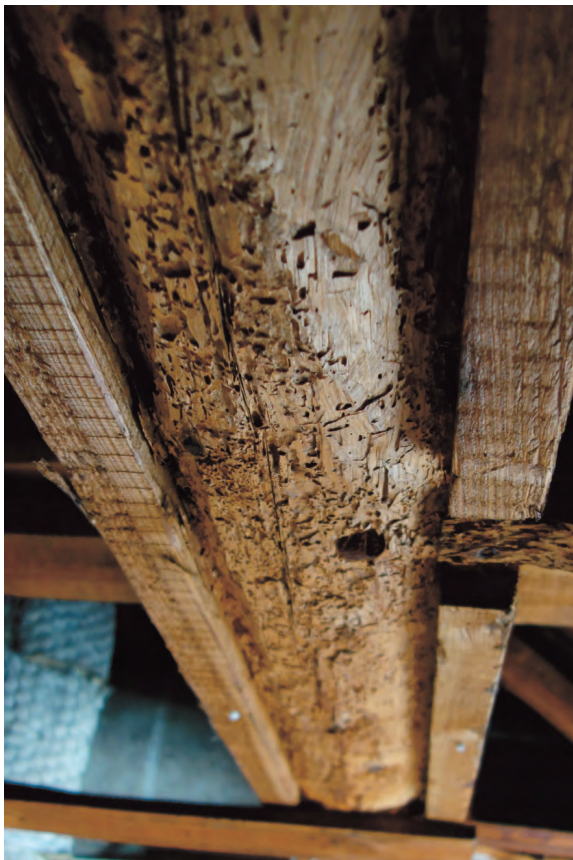
Renbyggna hjälkar uppvisar stora angrepp av busbock. Dessa har kompletterats med regler på vardera sida.
