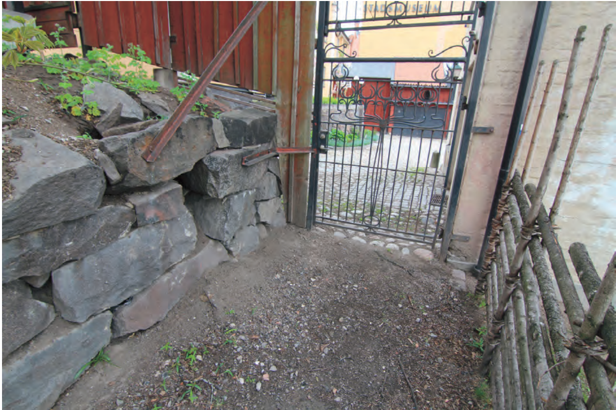
Passagen mot fastigheten Bergsbron 8. Stag är fästa i den kallmurade stengrunden som har börjat röra på sig. Smidesgrinden står låst.
