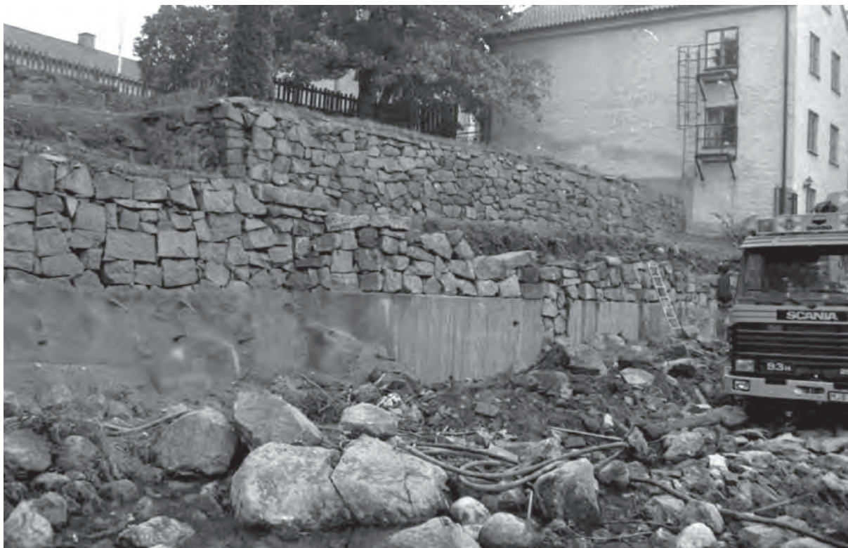
Foto från arbetet med att renovera strömmens stenskoning 1991. Stenmuren till höger har plockats ned i sin helhet och flyttats ut något i strömmen för att gå i linje med övrig strandskonig. Strandlinjens form har dock bevarats. Träden har fällts och nya betongfundament gjutits upp för att placera murarna på, därefter betonginjekterades murarna. Fundament till vänster är troligen endast renoverat med betong och utgör det äldre bredare fundamentet. Foto från Norrköpings stadsmuseum.
