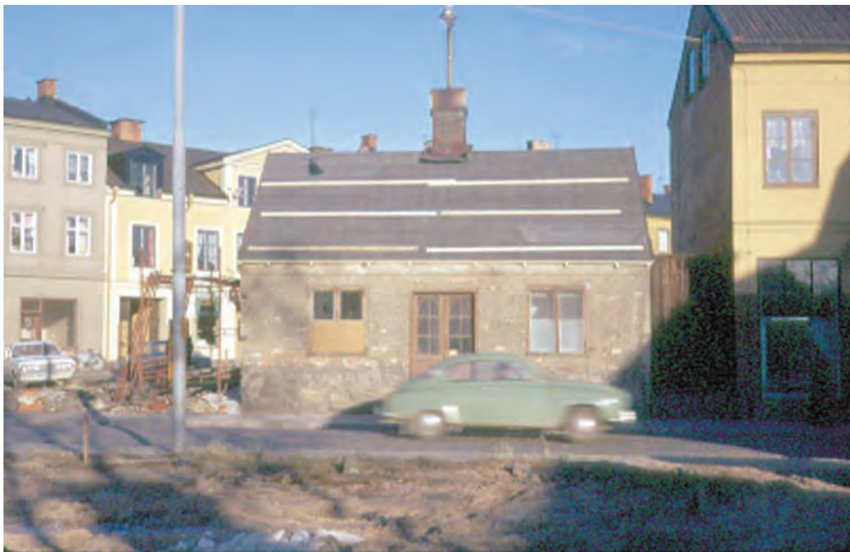
"Sista supen" har fått nytt underlagstak, ny papp och av allt att döma delvis även nya takstolar. Foto från 1971, Norrköpings stadsmuseum.
