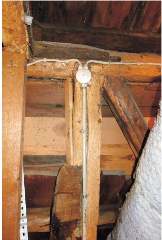
Synlig stomme invändigt, uppstolpning för italianen. Timmer är kraftigt angripen av husbock, angreppet bedöms ej vara aktivt och är tidigare åtgärdat.
