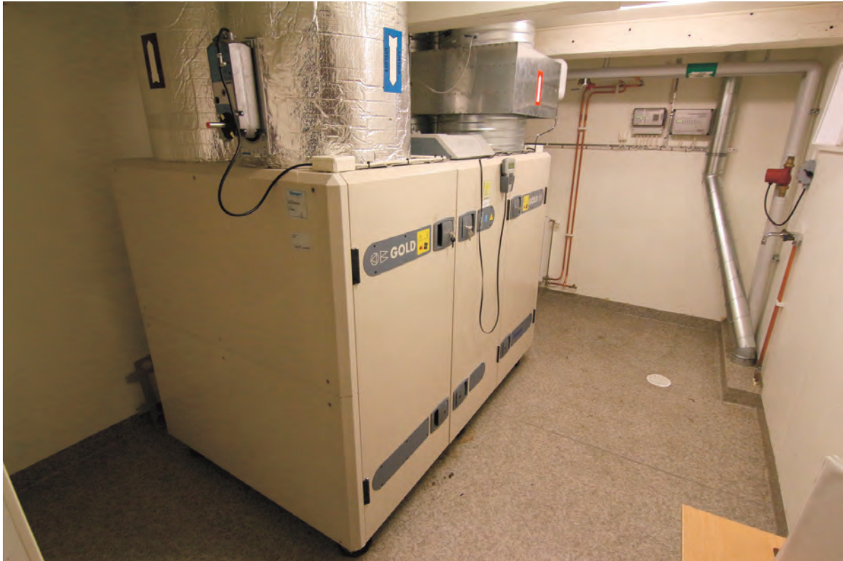
Installationsrum på vinden, centralt placerad mot norr. Rummet har svetsad tät matta och är avdelat som brandcell.
