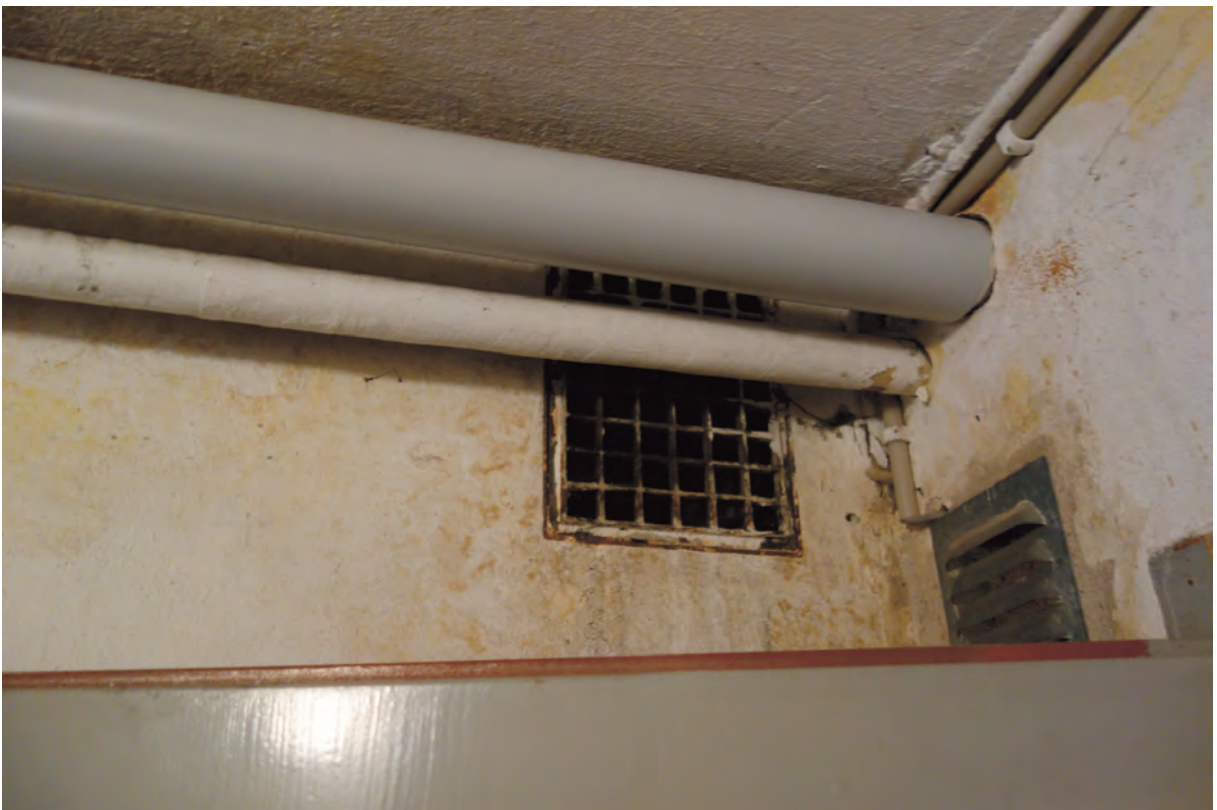
Ventilationsgaller i källarens förrådsrum, från ombyggnationen 1932 då källaren utökades till livsmedelsförråd.
