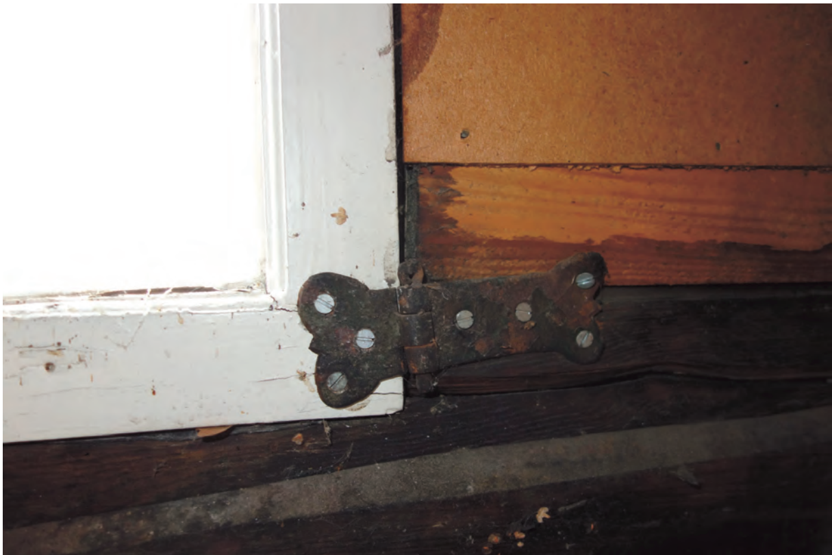
Smidda gängjärn på fönster i italian. Troligen svartbrända vid smidesprocessen, infästningen senare bytt mot galvaniserad skruv.
