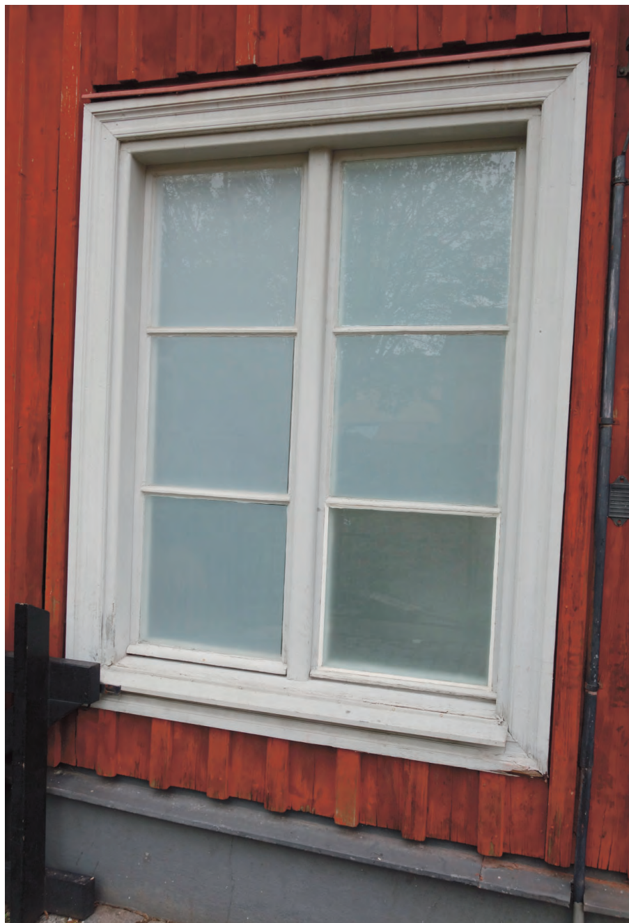
Fönster på östra sidans gavel på bottenvåning. Fönstret är inåtgående och har en mer försänkt utformning än tidiga fotografier från sekelskiftet 1900 visar. Troligen byttes fönster vid ombyggnad på 1930-talet. Omfattningar är troligen av betydligt högre ålder och återanvända.
