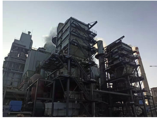
石灰窑燃烧废气脱硝系统
