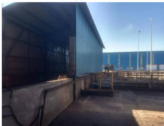
车辆冲洗设施
