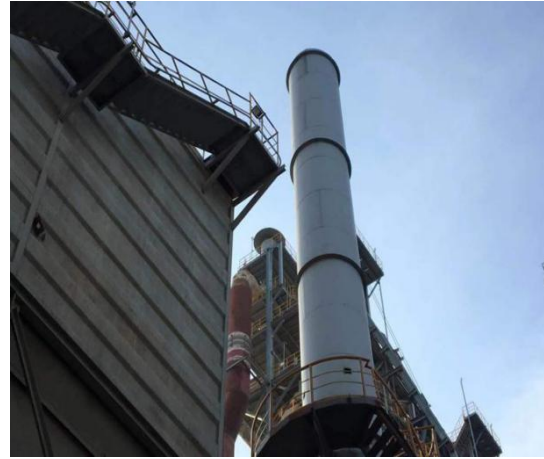
成品除尘系统（排气筒）
