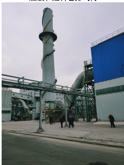
3#烧结配料室除尘排气筒
