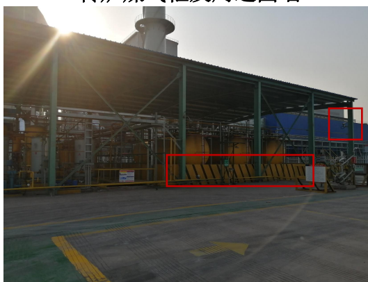
液氨储罐及应急防护措施
