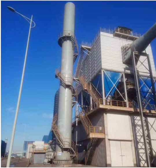
转运站除尘系统（排气筒）
