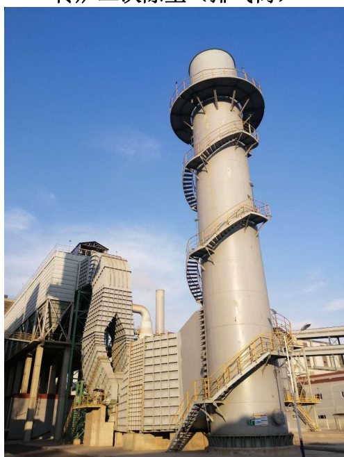
4#精炼废气除尘系统（排气筒）
