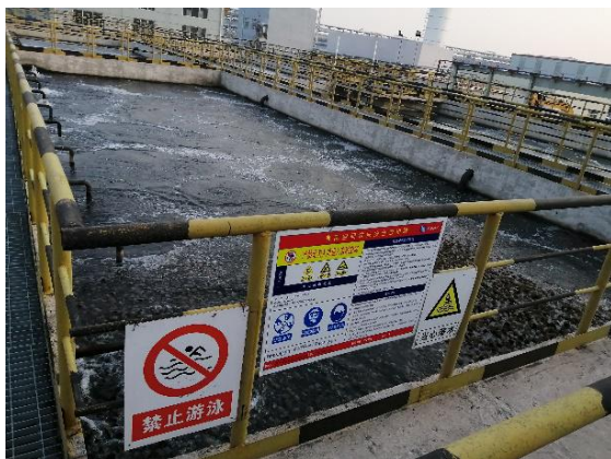
污水处理站调节池
