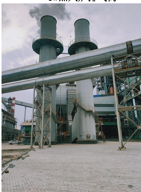
2#高炉1#、2#出铁场排气筒
