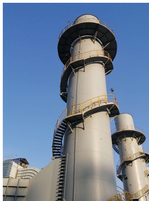
转炉三次除尘系统（排气筒）
