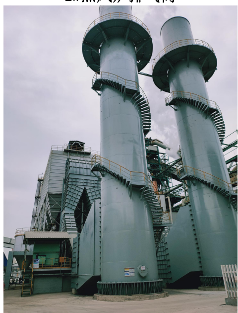
3#高炉1#、2#出铁场除尘系统
