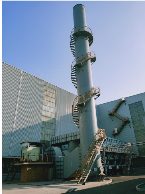
精轧废气除尘系统（排气筒）
