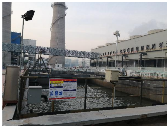
综合污水处理站
