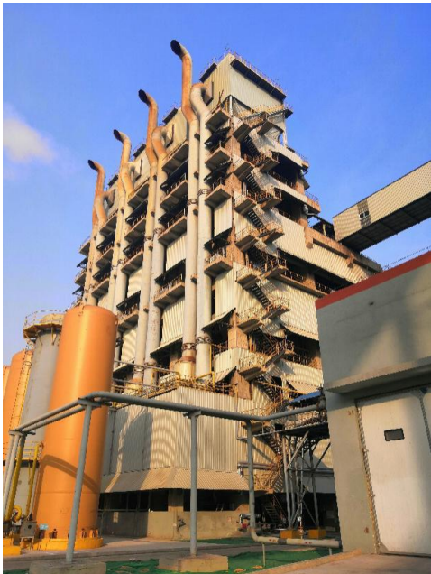
煤粉制备除尘系统（排气筒）
