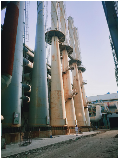
热风炉烟气处理系统（排气筒）
