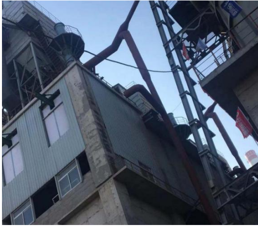
转运站除尘系统（排气筒）
