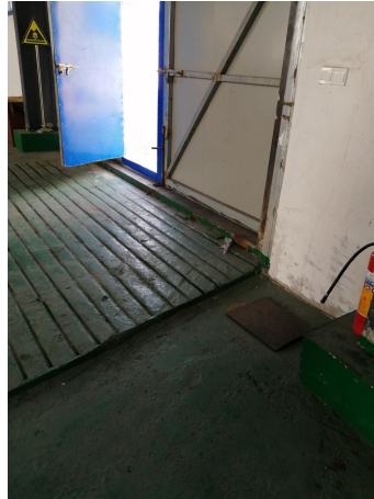
危废暂存间门口设截流措施
