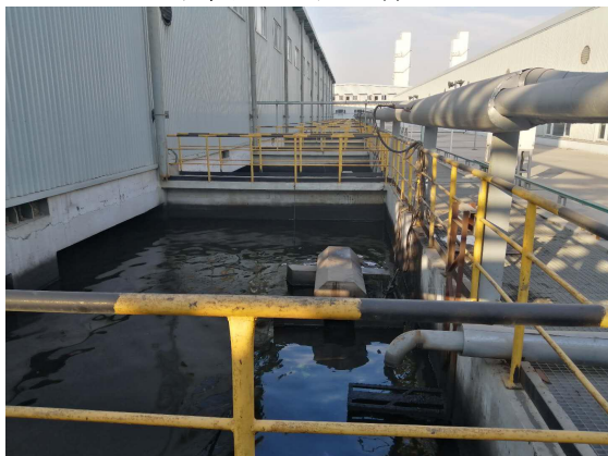
轧钢浊环水平流沉淀除油池
