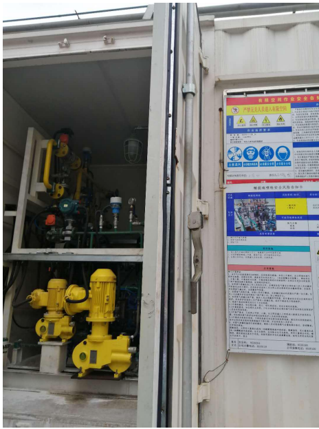
高炉煤气脱硫系统
