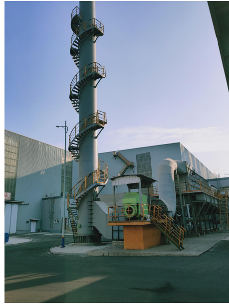
粗轧废气除尘系统（排气筒）
