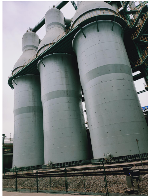
高炉煤粉除尘
