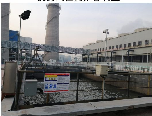
综合污水处理站
