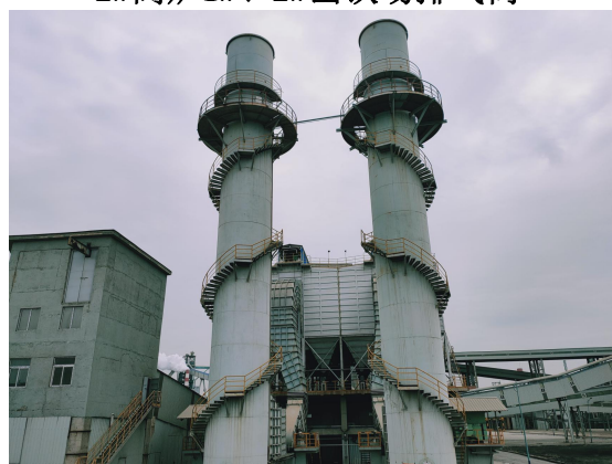
矿槽除尘系统
