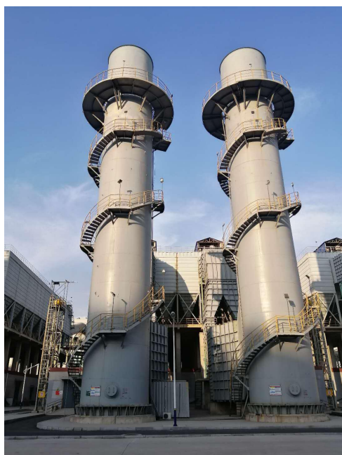
转炉二次除尘（排气筒）
