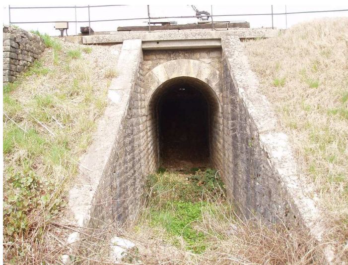
Photographie 19 : ouvrage de décharge obstrué dans la voie ferrée
