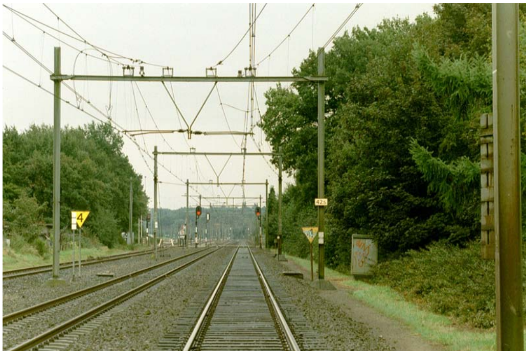
Figuur 108 Overzicht geleiders 1500 V DC -baanvak. Bovenleidinggeleiders, 2 rijdraden + draagkabel + versterkingsleiding; retour, spoorstaven.
