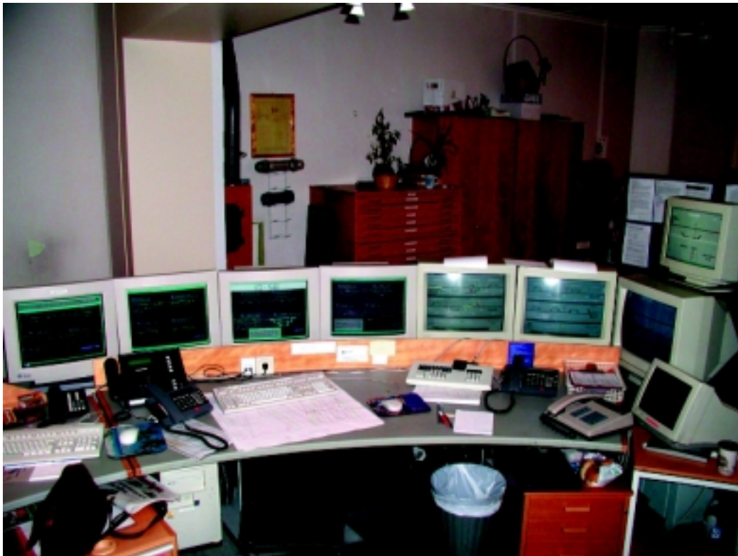
Figur 6.2 Arbeidsplassen for overvåking av Rørosbanen og strekningen Hamar– Eidsvoll. VICOS-skjermer til venstre og -skjermer for Rørosbanen til høyre
