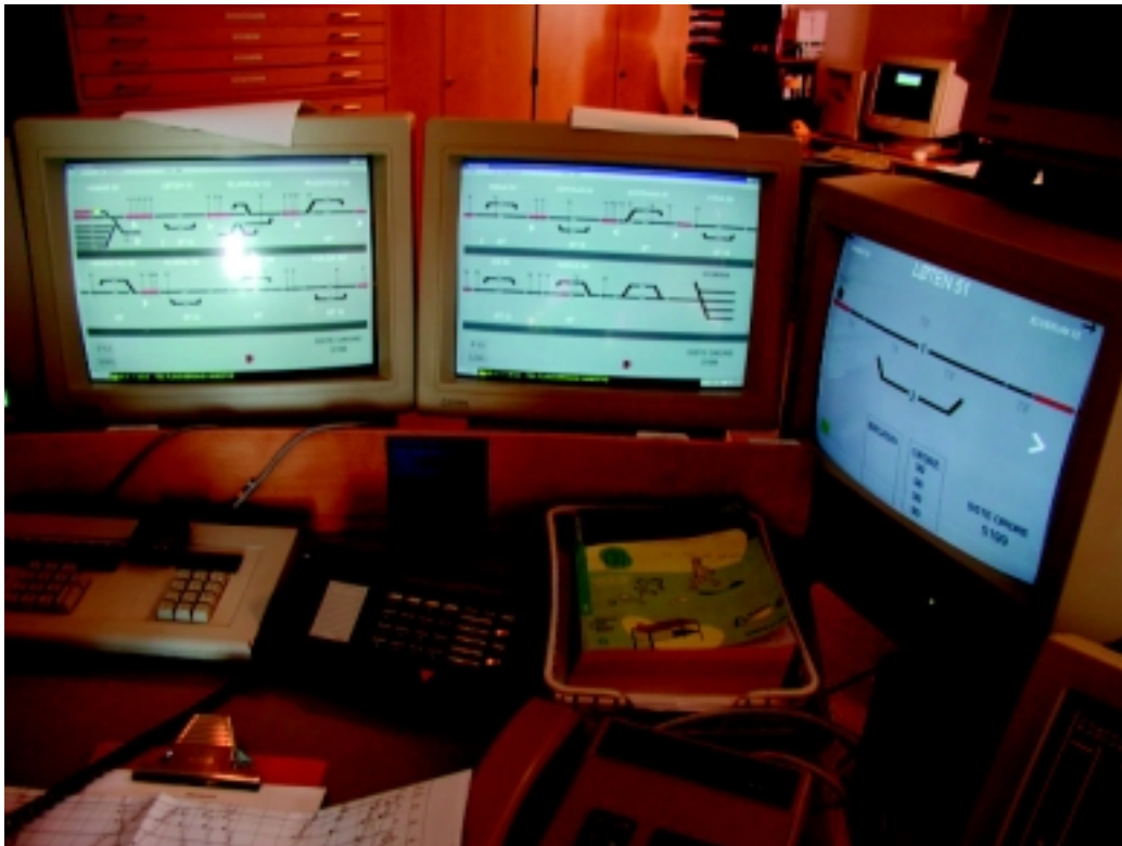
Figur 4.1 Fjernstyringsanlegget for Rørosbanen med to oversiktsskjermer og to detaljsskjermer
