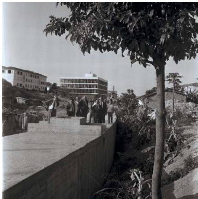
Figura 08 - Obras de canalização do Leitão na Avenida Prudente de Moraes em 1970. Ao fundo o Conjunto IAPB e uma cafuná que integrava a Favela da Alvorada. Fonte: APCBH/ASCOM.
