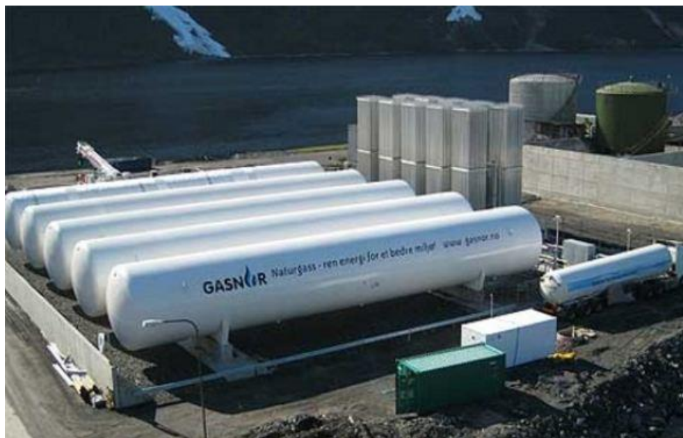
Figur 5:3 Exempel på vacuumisolerade LNG lagringstankar
