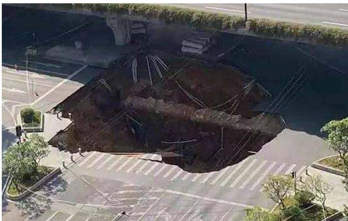
图示:地面塌陷区航拍照片
