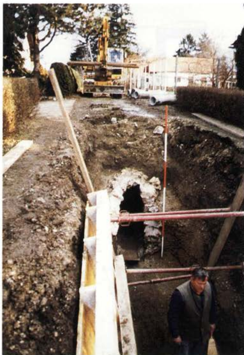
Ptuj, 1997, Vespazianova ulica. Pri izkopu za moderno kanalizacijo smo dokumentirali rimskodobno poetovionsko ulično obokano kloako (foto Marija Lubšina - Tušek).
