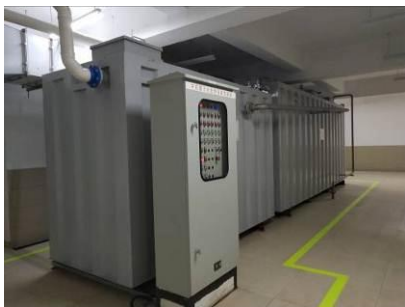
中控室污水成套处理设备
