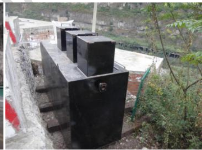
承包商营地生活污水处理设备
