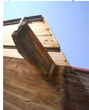
57) Mallia weathered truss 07/05
