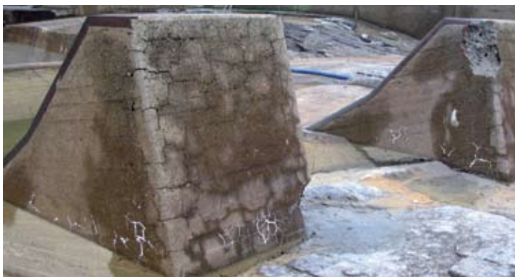
Typiska ASR-skador vid Vattenfalls anläggning Långbjörn.
