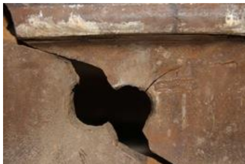
Gambar 7. Lubang baut tidak sempurna
