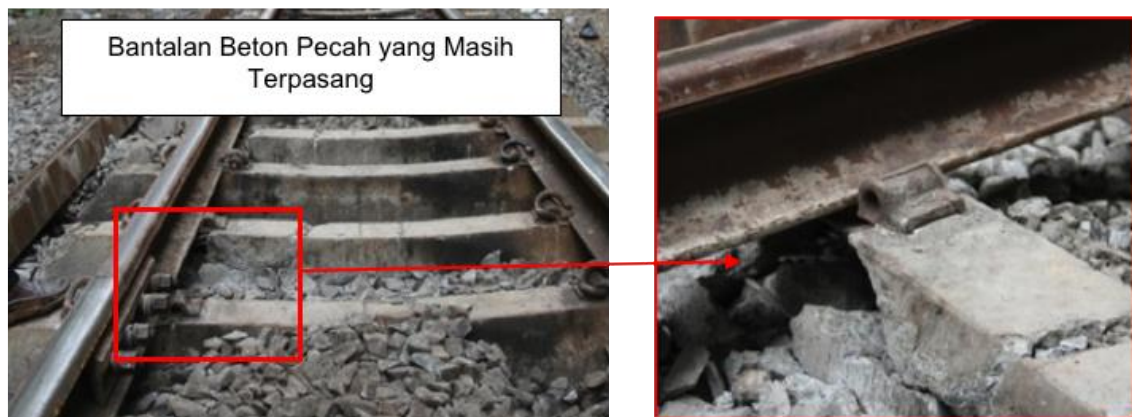
Gambar 10. Bantalan beton di bawah sambungan rel yang pecah lama
