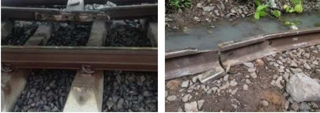
Gambar 5. Rel patah pada sambungan rel di Km 262+100/200
