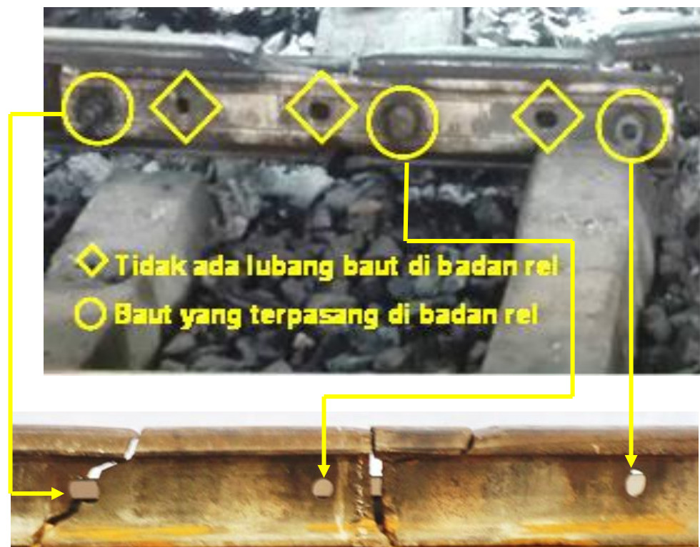
Gambar 25. Konfigurasi pemasangan pelat sambung Km 262+151 petak jalan antara Sta. Lubuk rukam – Sta. Peninjawan
