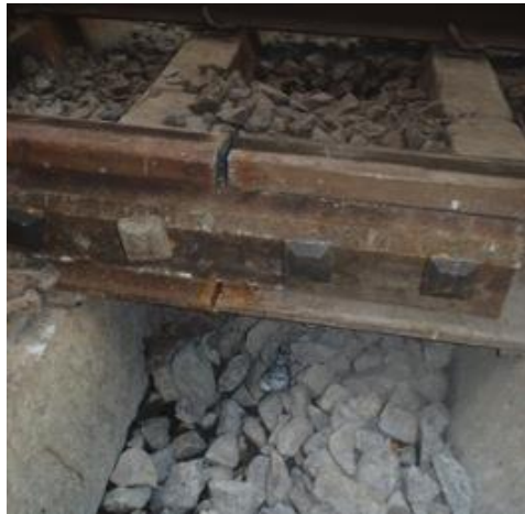
Gambar 8. Jalan rel di sekitar lokasi kejadian kurang ballast
