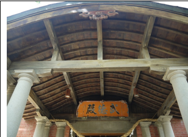
相 3-2.22 高雄武德殿唐博風屋頂構造。桁木上立束以支撐母屋，再置放弓形樺木及屋頂板。
