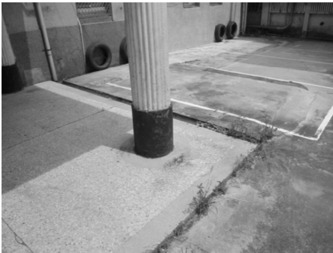
相 4-4.5 屏東演武場門廊地板現況
