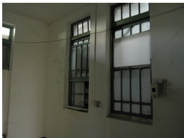
相 4-4.33 東面北邊的木作上下疊窗現況
