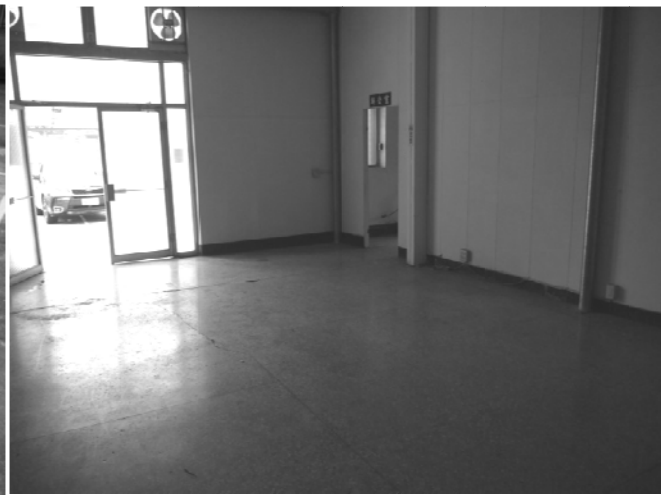
相 4-4.6 屏東演武場室內地坪現況
