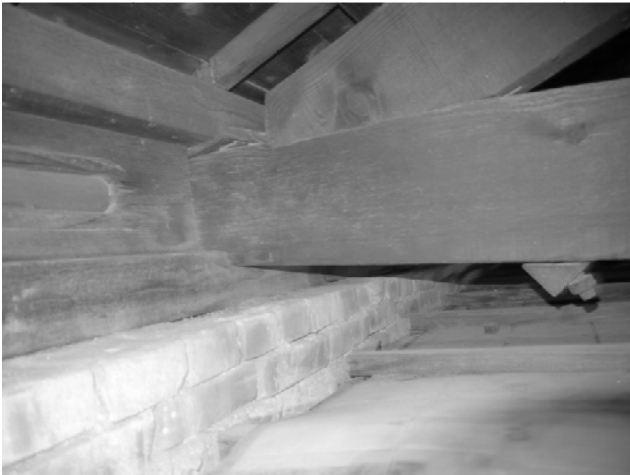
相 4-3.13 磚牆頂並無混凝土圈梁設計。北面室內。
