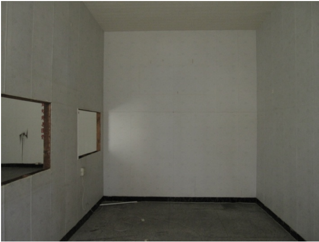
相 4-3.7 室內中軸東側空間
