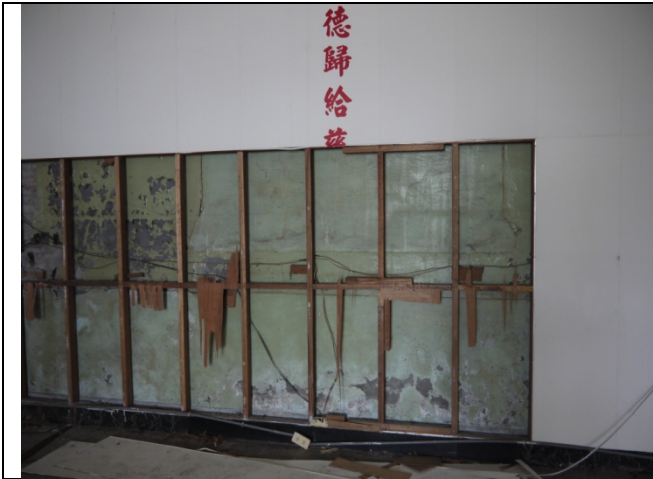
相 3-2.15 神龕已被砌磚封閉，但原開口裂縫明顯。北側牆室內現況。
