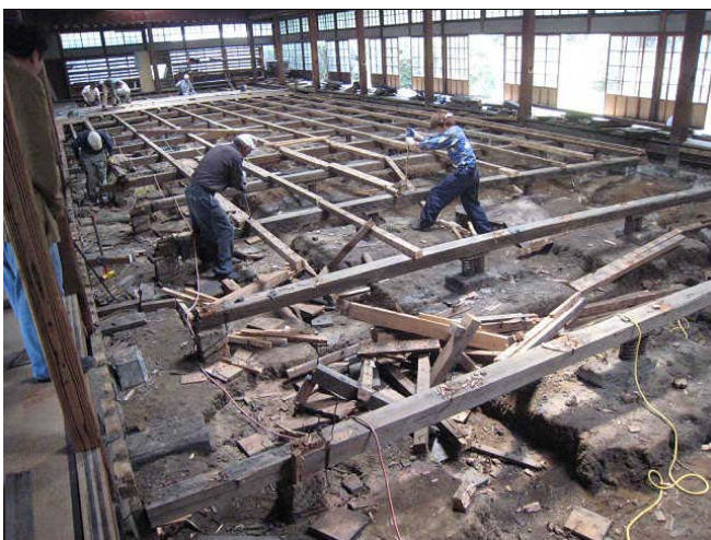
相 3-2.31 日本一流劍道館彈性架高地板施工 資料來源：劍視の BLOG 網站
