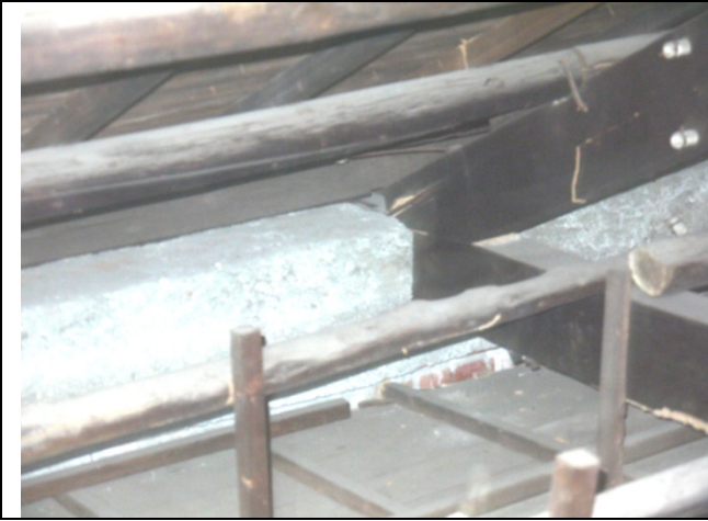
相 3-2.20 屋架陸梁直接置放於混凝土板凹槽中被束制
