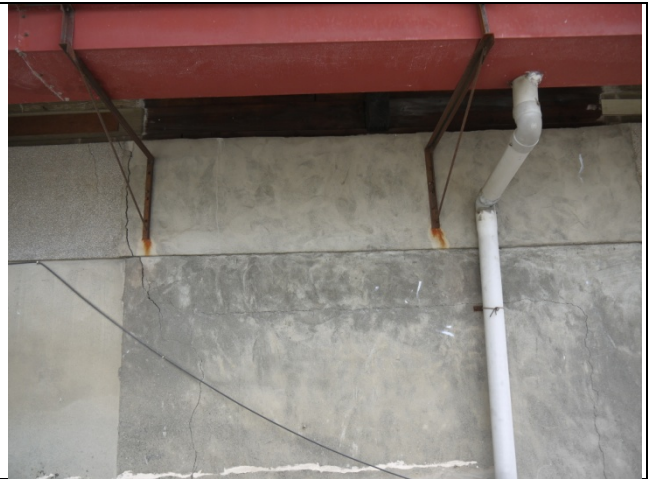
相 3-2.16 神龕已被砌磚封閉，但原開口裂縫明顯。北側牆室外現況。
