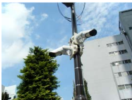
▲防犯カメラの設置
