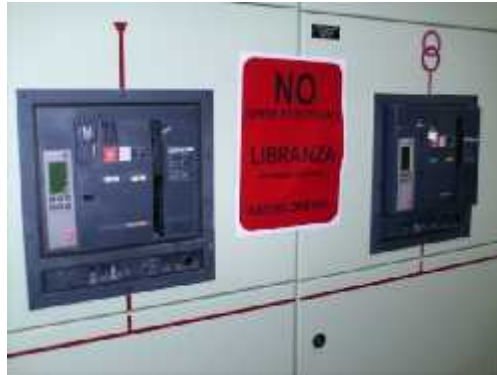
Fig. 5.3.10 Interruptores 52a y 52b
