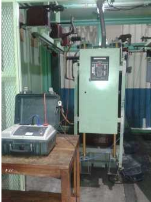
Fig. 4.3.2.3 Prueba de resistencia de aislamiento al transformador de excitación
