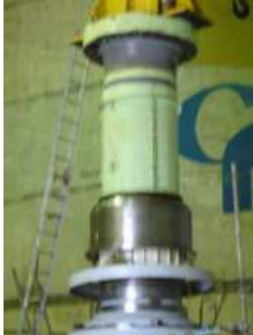
Fig. 2.2.2.8 Excitación del Generador.
