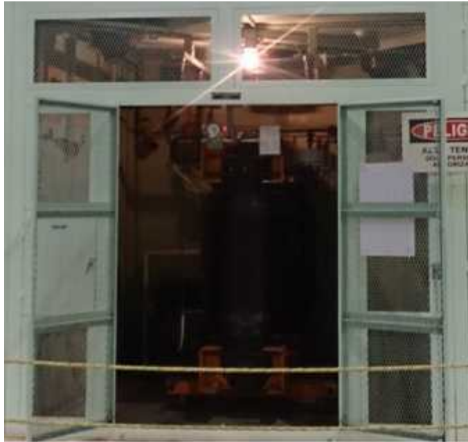
Fig. 1.4.5 Transformador de servicios propios.
