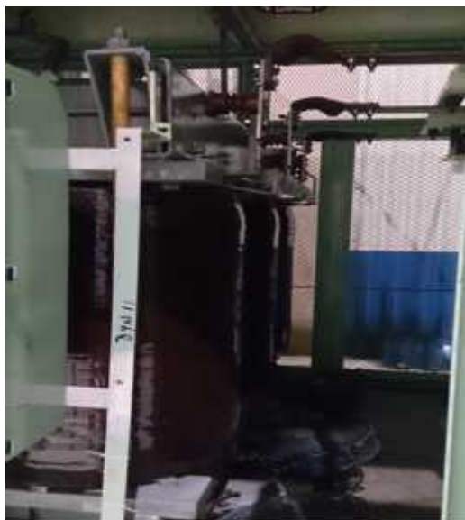
Fig. 1.4.6 Transformador de excitación.
