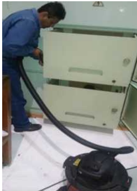
Fig. 4.3.4 Limpieza de gabinetes
