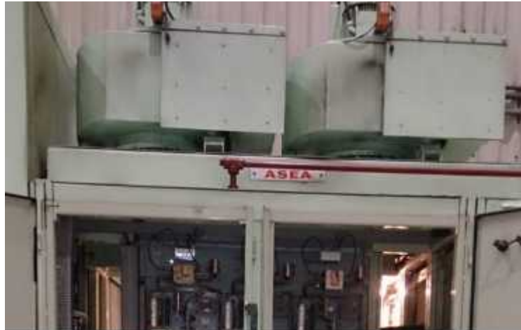
Fig. 1.4.10.1 Ventiladores del rectificador de tiristores.
