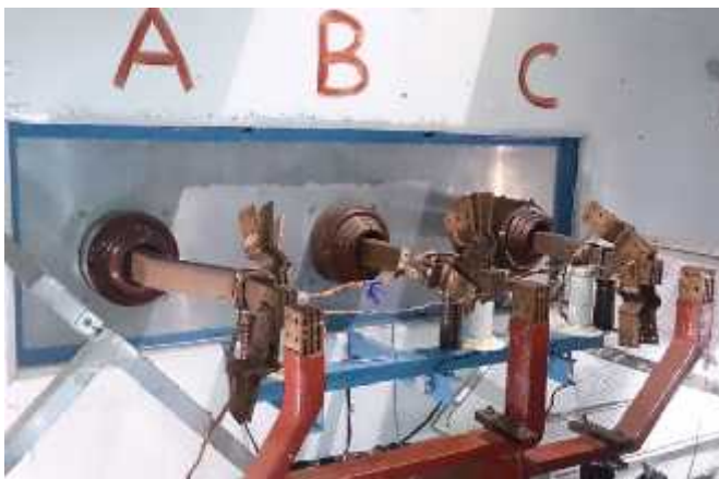
Fig. 4.1.1 Desconectando el generador
