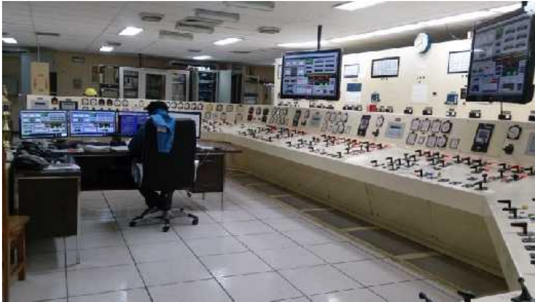
Fig. 1.4.1 Sala de control
