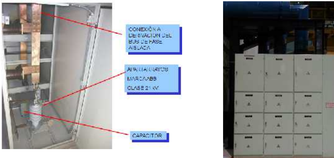
Fig. 1.4.8 Equipos de protección del transformador de potencial
