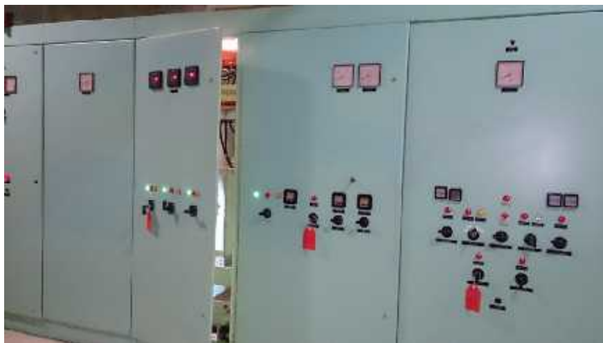
Fig. 5.3.8 Tablero de fuerza y control
