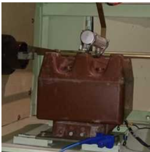
Fig. 1.4.8.1 Transformador de potencial marca Alstom
