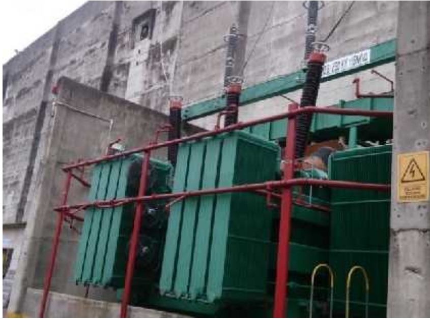
Fig. 1.4.7 Transformador de potencia
