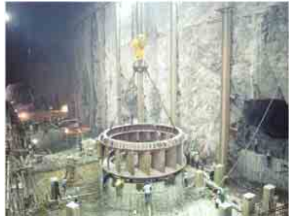
Figura II.3.3.2-81 Foto de un proyecto que ejemplifica el Montaje del antedistribuidor en su sitio en una de las unidades de casa de máquinas
