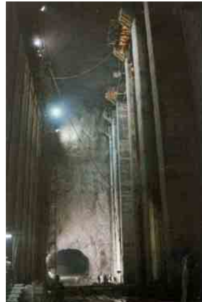
Figura II.3.3.2-59 Foto de un proyecto que ejemplifica las Etapas de excavación del túnel de desfogue
