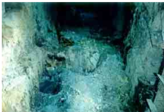
Figura II.3.3.2-49 Foto de un proyecto que ejemplifica la Excavación de los fosos de las unidades de casa de máquinas
