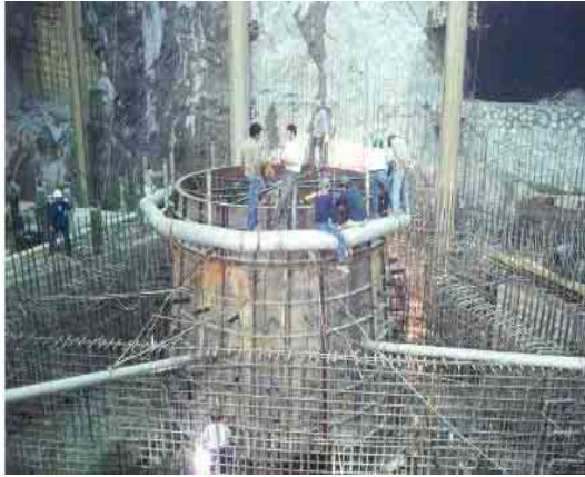
Figura II.3.3.2-80 Foto de un proyecto que ejemplifica la Vista de los conos superior e inferior del tubo de aspiración
