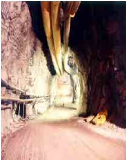
Figura II.3.3.2-42 Foto de un proyecto que ejemplifica un Túnel de acceso a casa de maquinas y bifurcación a túneles auxiliares
