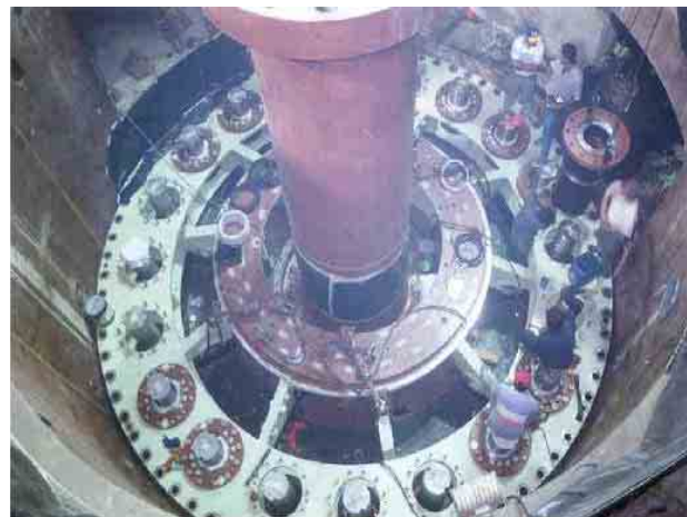
Figura II.3.3.2-83 Foto de un proyecto que ejemplifica la Colocación de la turbina, la flecha de la turbina y la colocación de los cojinetes superiores de los álabes móviles
