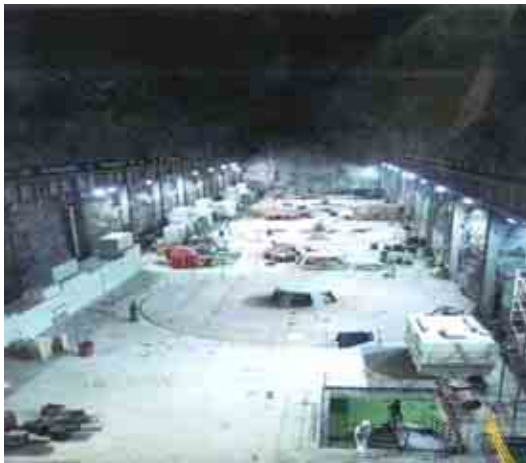
Figura II.3.3.2-86 Foto de un proyecto que ejemplifica la Vista panorámica de casa de máquinas donde se muestran las posiciones de los generadores de potencia
