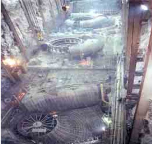
Figura II.3.3.2-82 Foto de un proyecto que ejemplifica la Vista general de casa de máquinas, obsérvese el tubo de aspiración en una unidad, la carcasa antedistribuidor en otra y al fondo la carcasa espiral
