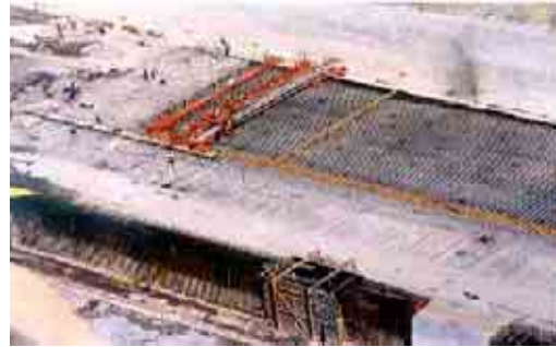
Figura II.3.3.2-69 Foto de un proyecto que ejemplifica la Cimbra deslizando en los concretos en zona del canal de descarga.
