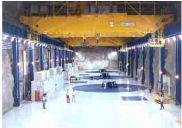
Figura II.3.3.2-87 Foto de un proyecto que ejemplifica la Vista general de casa de máquinas concluida.
