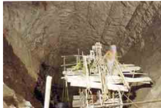
Figura II.3.3.2-37 Foto de un proyecto que ejemplifica los Tratamientos de la roca en tuberías a presión, mediante uso de track-drill montado en plataforma
