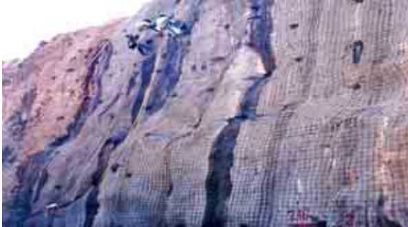
Figura II.3.3.2-24 Foto de un proyecto que ejemplifica el Tratamiento de taludes con mortero y malla electrosoldada
