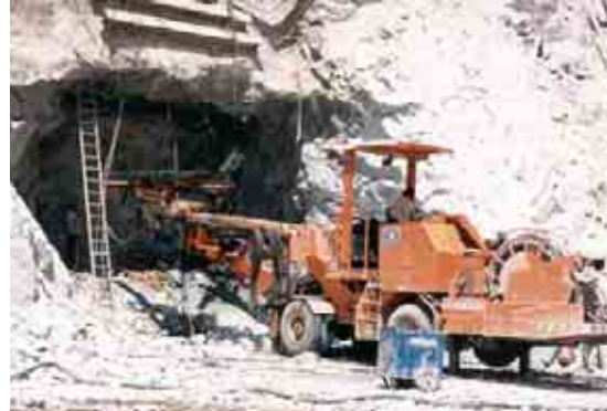
Figura II.3.3.2-31 Foto de un proyecto que ejemplifica el Proceso inicial de excavación de las bocatomas
