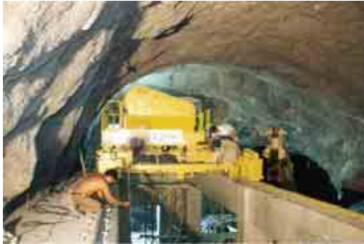
Figura II.3.3.2-76 Foto de un proyecto que ejemplifica el Montaje del carro de la grúa pórtico sobre traves carril
