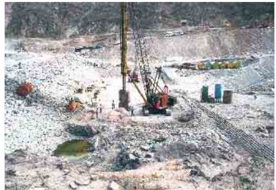
Figura II.3.3.2-14 Foto de un proyecto que ejemplifica la Construcción de la pantalla flexoimpermeable en la ataguía de aguas abajo con grúa almeja
