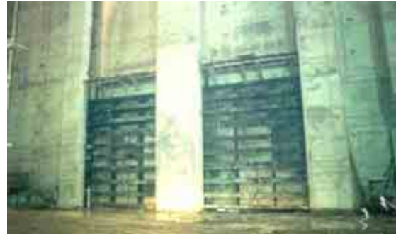
Figura II.3.3.2-77 Foto de un proyecto que ejemplifica el Compuertas en pozos de oscilación
