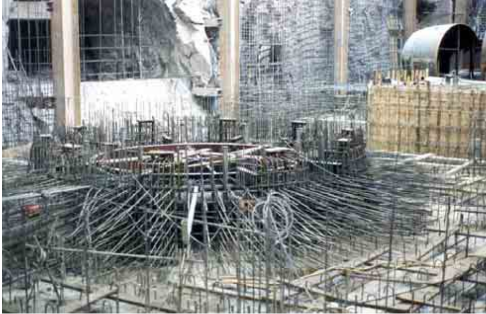
Figura II.3.3.2-55 Foto que ejemplifica un Anclaje en la caverna de casa de máquinas
