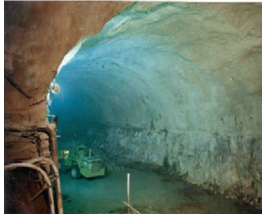
Figura II.3.3.2-45 Foto de un proyecto que ejemplifica la Excavación de banquetes de la caverna de casa de máquinas. Etapa 3
