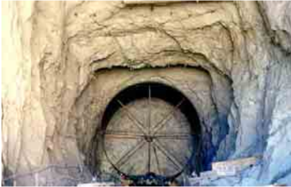
Figura II.3.3.2-38 Foto de un proyecto que ejemplifica el Proceso de lanzamiento de tubos para conformar el blindaje de las tuberías a presión tuberías a presión.
