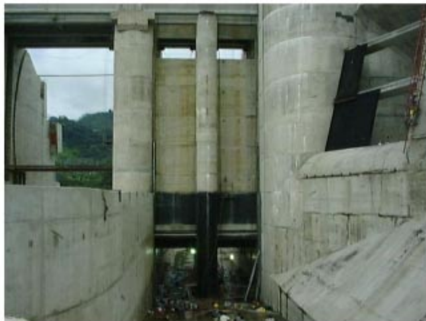
Figura 12.- Compuertas de descargas de fondo. A la derecha, la toma de aguas
