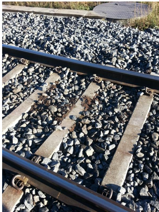
Figur 7. En skvättsträcka på Malmbanan. Runt den mittersta slipern har finmaterial vandrat upp i ballasten.
