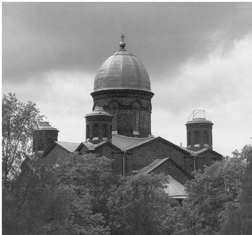
Kuva 134. Kirkon sivutornit ennen uusinta korjaustaan. Tambuureissa näkyvät muuratut, kolmiulotteiset tiilidetallit.
