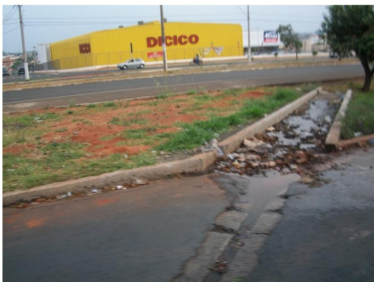
Figura 36 - Vista de Lixo Acumulado num Trecho de Drenagem Superficial.
