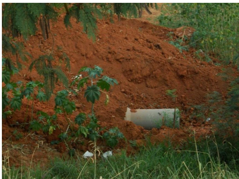
Figura 41 - Vista das Condições Inadequadas de Execução do Talude.
