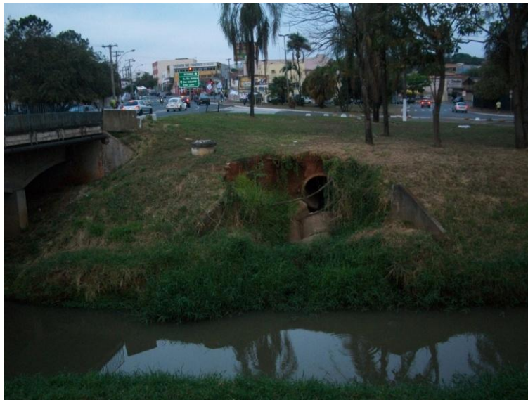
Figura 45 - Erosão no Desemboque de uma Galeria de Águas Pluviais no Ribeirão dos Toledos.
