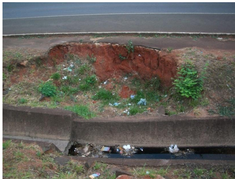
Figura 44 - Vista da Erosão Quase Atingindo a Avenida Santa Bárbara.
