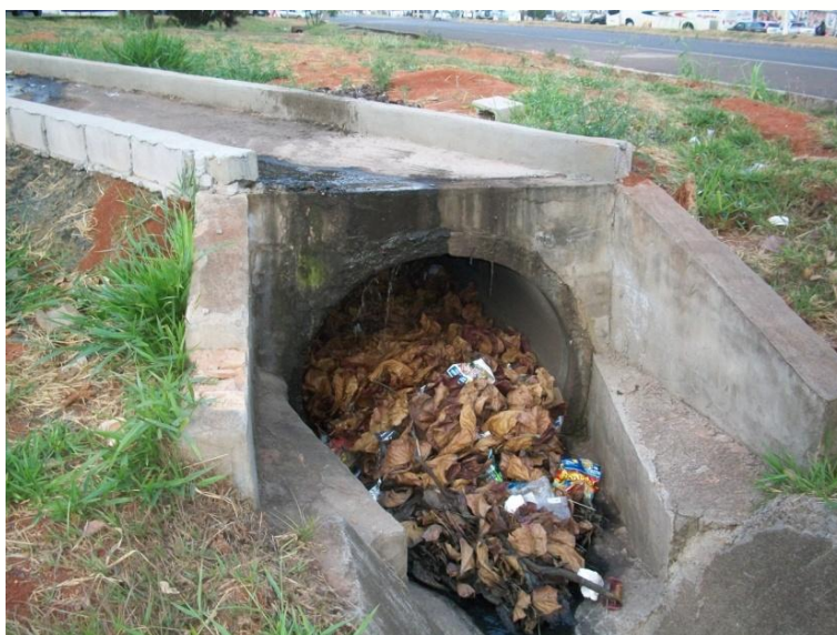
Figura 37 - Vista da Presença de Folhas obstruindo a Entrada de uma Galeria de Águas Pluviais.
