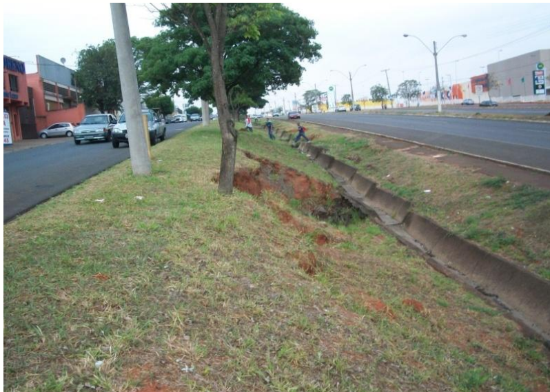
Figura 43 - Vista de um dos Pontos de Erosão no Talude Junto à Drenagem Superficial.
