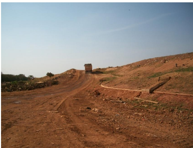
Figura 70 - Drenagem de Águas Pluviais e Dreno de Gás do Aterro Sanitário.
