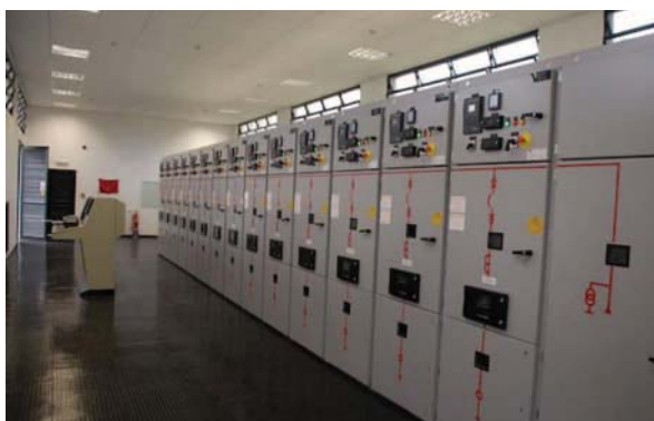
Figura 24.1 – Subestação primária de energia de 13,7 kV e 30 MVA, inaugurada em 2010
