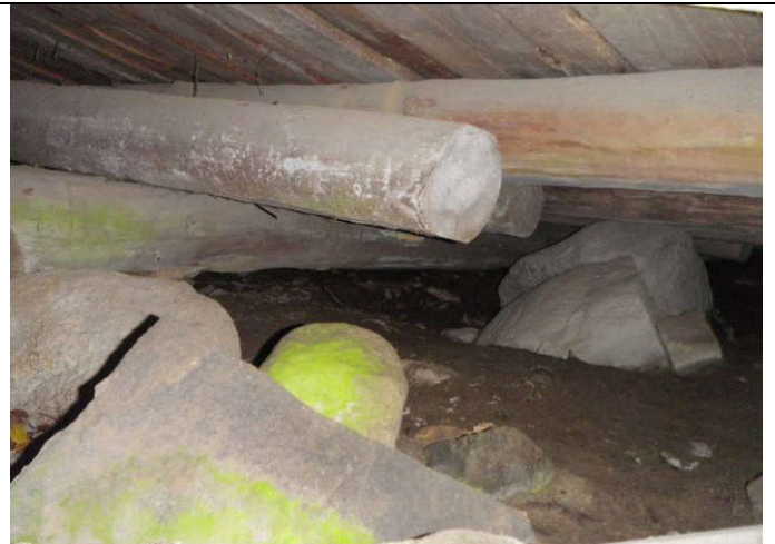
Kuva 4. Alapohjan tuenta on pettänyt. Ryömintätilan korkeus on vähäinen
