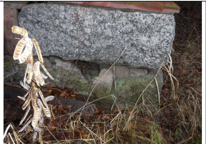
Kuva 2. Perustukset ovat rikkoutuneet ja liikkuneet.
