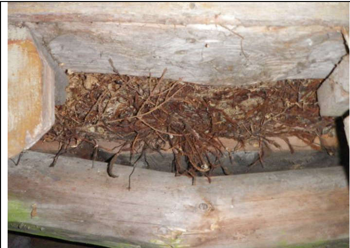
Kuva 3. Alapohja on osittain sortunut kannakkeiden katkettua. Eristeenä on sammalta yms. orgaanista ainetta.
