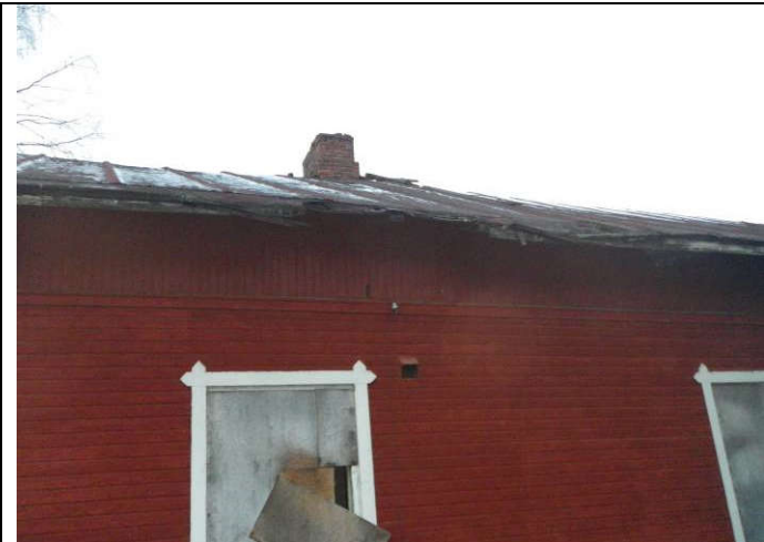
Kuva 8. Vesikate on rikkoutunut ja räystääs osittain lahonnut
