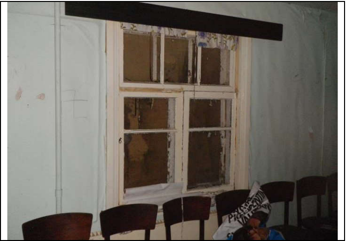
Kuva 7. Rikottu yläkerran ikkuna
