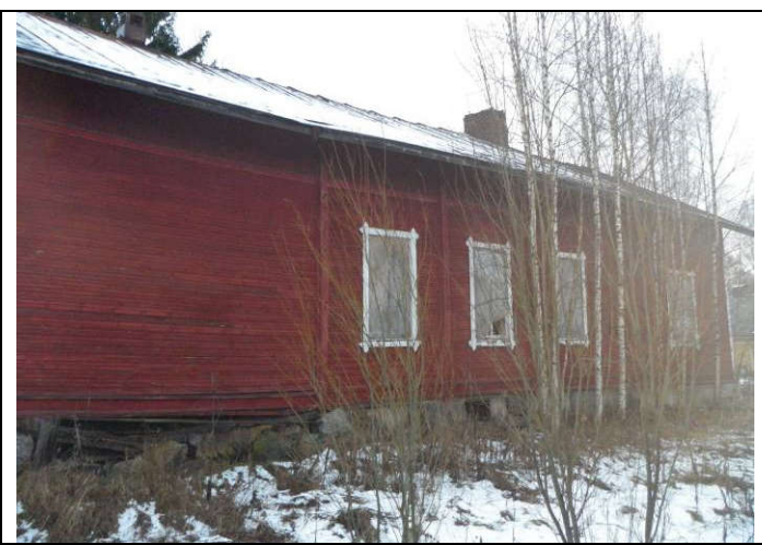
Kuva 5. Julkisivuissa on suuria painaumia
