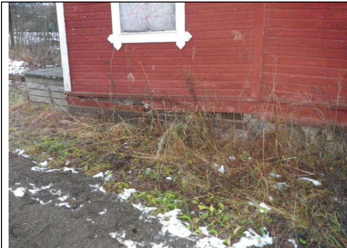
Kuva 1. Perustukset ovat painuneet. Päädyssä oleva lautarakenteinen osa on painunut huomattavasti.
