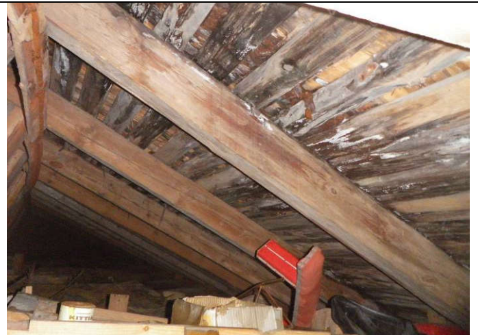
Kuva 9. Vesikatossa on vuotoja ja alusrakenteet lahonneet.
