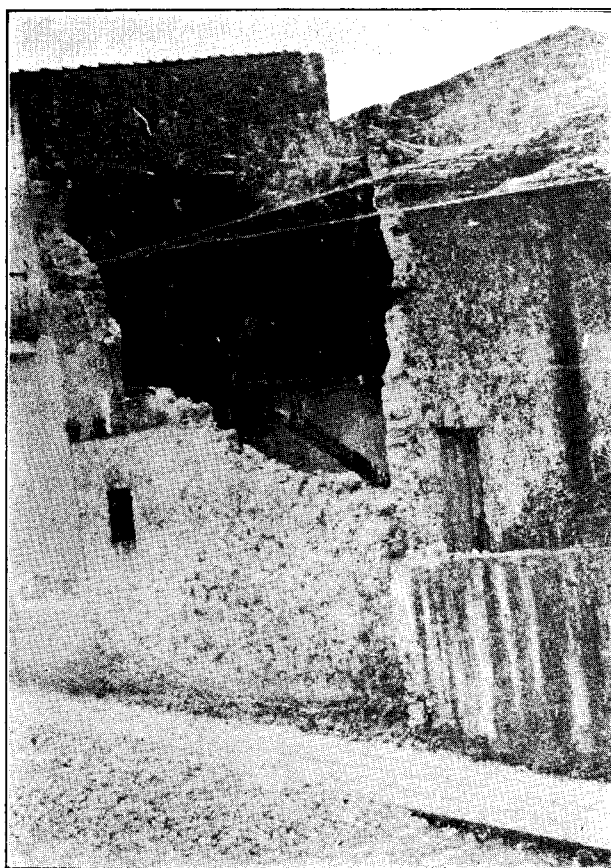
Fotografía número 2.—Teocelo, Ver. Casa destruída en la calle que conduce de la estación del Ferrocarril de Jalapa a la plaza de Teocelo.
