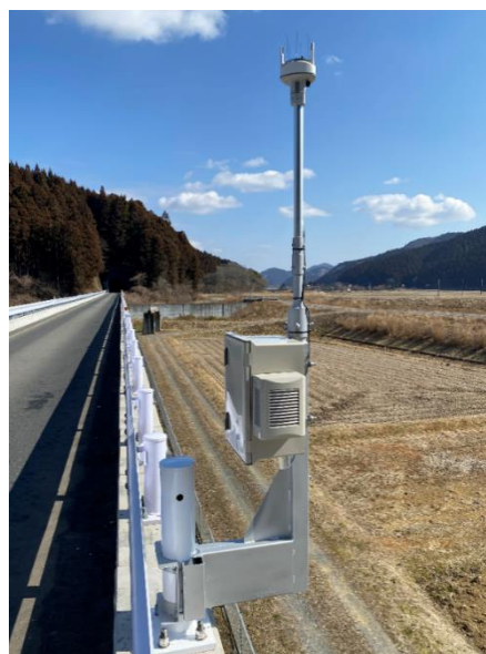
図 3 : 自動運転区間に設置された風速計
