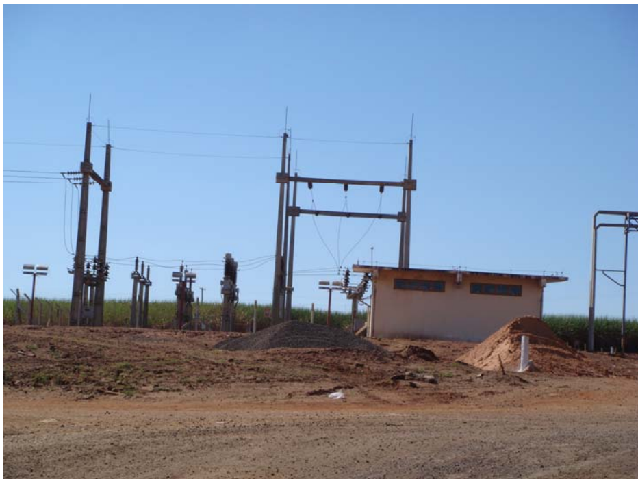
Figura 4.3 – Transmissão da energia da usina Santa Cândida Fonte: Estudo de caso.
