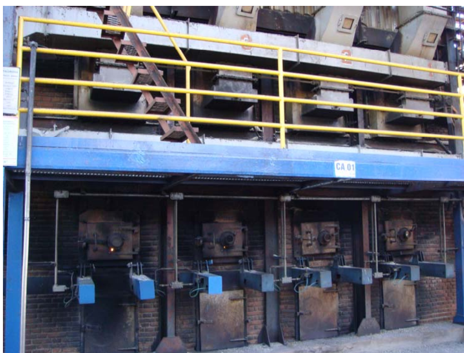
Figura 4.4 – Caldeiras da usina Santa Cândida Fonte: Estudo de caso.
