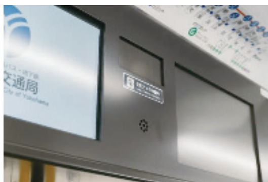
写真6 車内防犯カメラ
