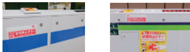
▲非常停止ボタン
