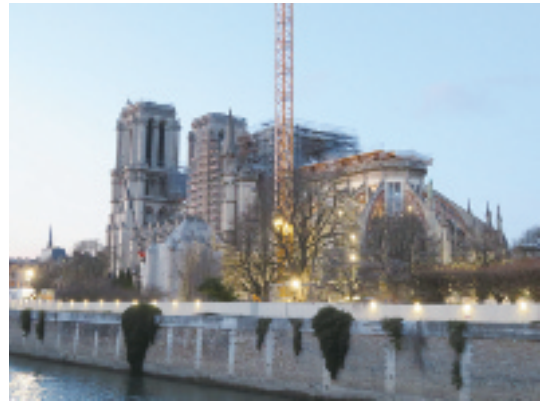
写真-27 ローマ=カトリック教会のノートルダム大聖堂(1250年完成)は、セーヌ川のシテ島にあり、ゴシック建築を代表する建物である。周辺の文化遺産とともに1991年にユネスコの世界遺産に登録されている。訪問時には修復工事が行なわれていた。(北西を見る。2020年1月29日)
