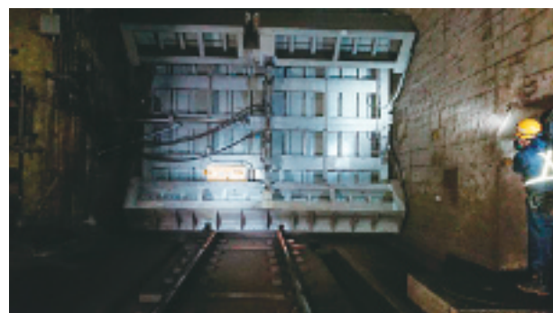
▲トンネル内防水扉
