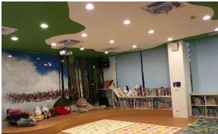
圖23-1 臺中九德國小說故事區照明
