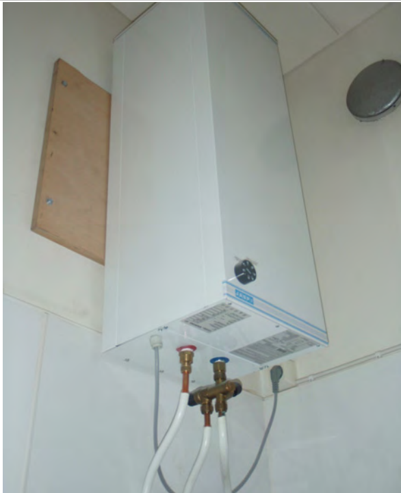
Jäspi-merkkinen käytössä oleva sähkökäyttöinen vedenlämmitin 2. kerroksen huoneessa 221 (wc).
