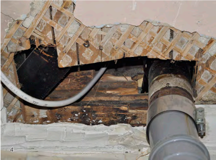
Kuva: 2.kerros WC:n viemärin läpivienti huoneen 106 katossa.
