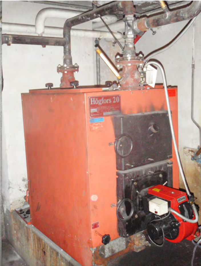
Rakennuksen öljykattila (Högfors 20) ja siihen asennettu kevytöljypoltin (Oilon KP 6) kattilahuoneessa (h 004).
