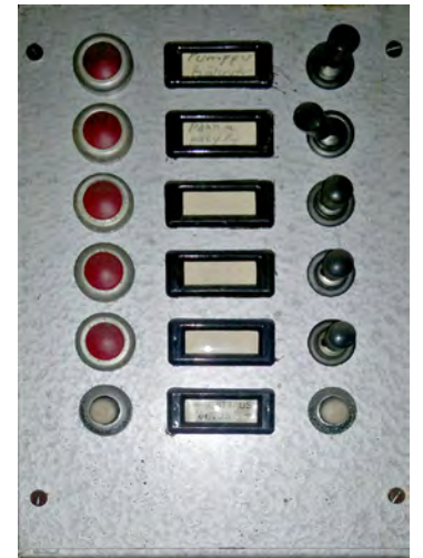
Käytöstä poistettu keskuslämmitysuhinin hälytysjärjestelmän paneeli pannuhuoneen seinällä.
