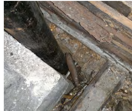
Yläpohjan vuotokohta tilassa 310.
