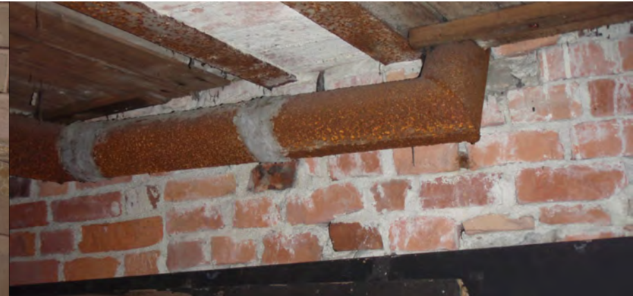
Kellarikerroksen ruosteinen ilmanvaihtojärjestelmään kuuluva putki.
