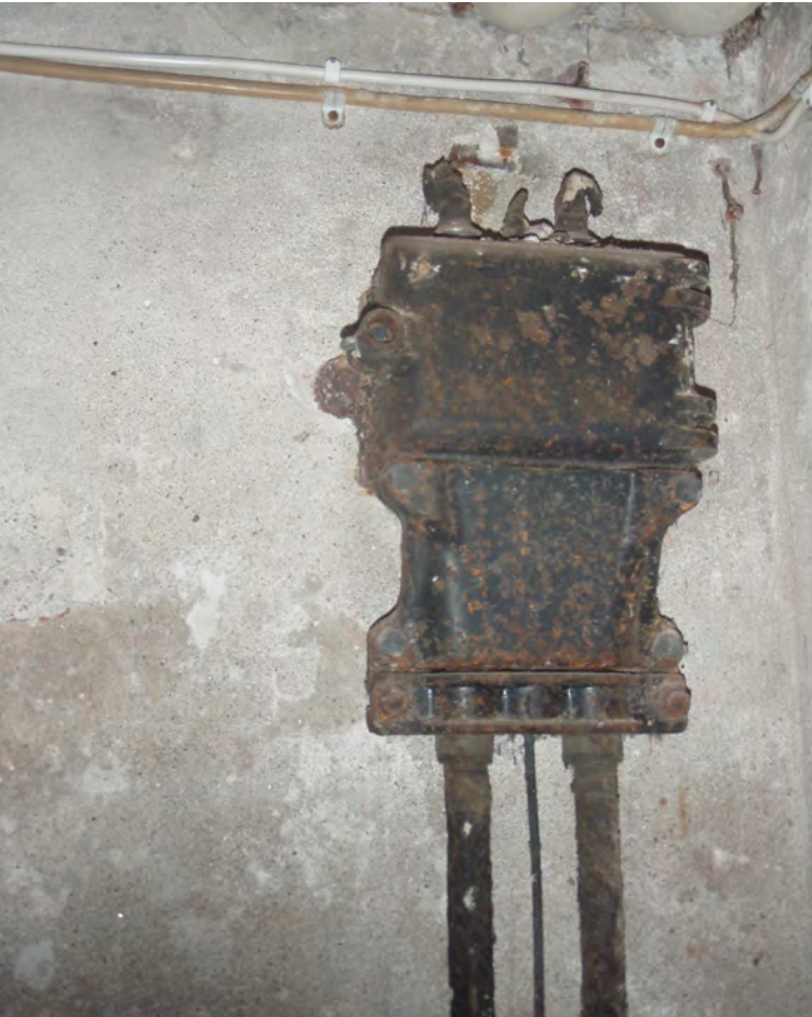
Kattilahuoneen seinältä löytyi vanha, käytöstäpoistettu, valurautainen suojalaatikko, joka on mahdollisesti vanha muuntaja (h 004).
