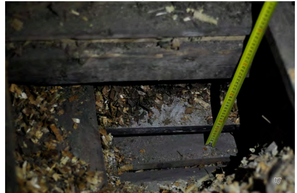
Kuva: Palanutta kutterinlastua huoneen 203 yläpuolella, avauskohta D
