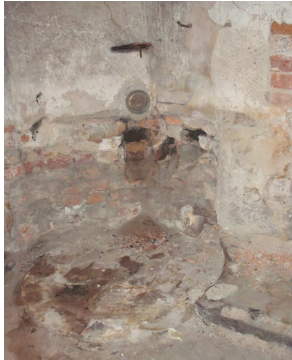
Vanhan vesipadan paikka kellarikerroksen huoneessa 001.
