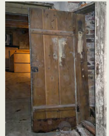
Kellarikomeron oio parioven KO-16 toinen puoli sisältä. Ulkopuolelta ovet on pahvitettu ja kehystetty listalla niin, että ne näyttävät peilioilta.
