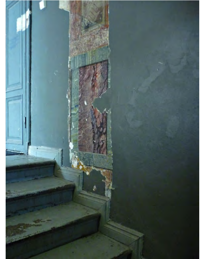
Portaan alimmassa juoksussa on vanhat, koristeelliset lattialistat, mutta toinen ja kolmas juoksu ovat listoitamattomat. Osa listoista on lahonnut pahoin.
