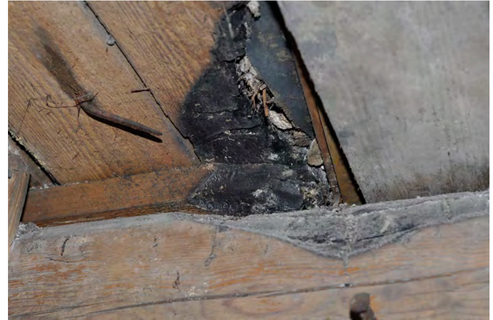
Kuva: Huone 11, palanutta välipohjan aluslaudoitusta kellarissa.
