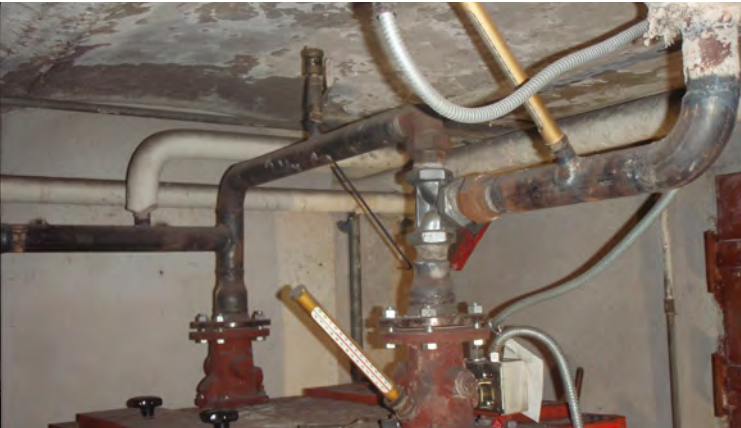
Meno- ja paluovesiputkien liittyminen lämpökattilaan.
