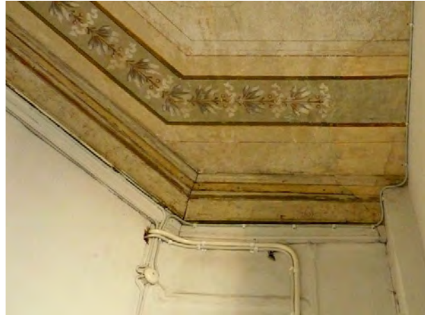
Huoneen 201 Stenbäckin-aikaisia kattolistoja ja koristemaalattua kattoa. Kattolistan alin osa on maalattu yli. Koristemaalauksia on paikattu keskukslämmityspiipun viereltä.
