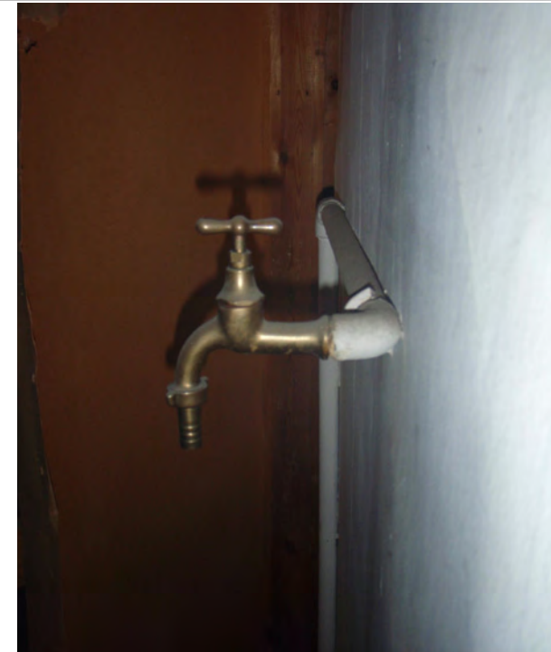
Vanha vesipiste pääportaiden yläpäässä 2. kerroksessa huoneessa 205. Vesipiste ei ole käytössä.
