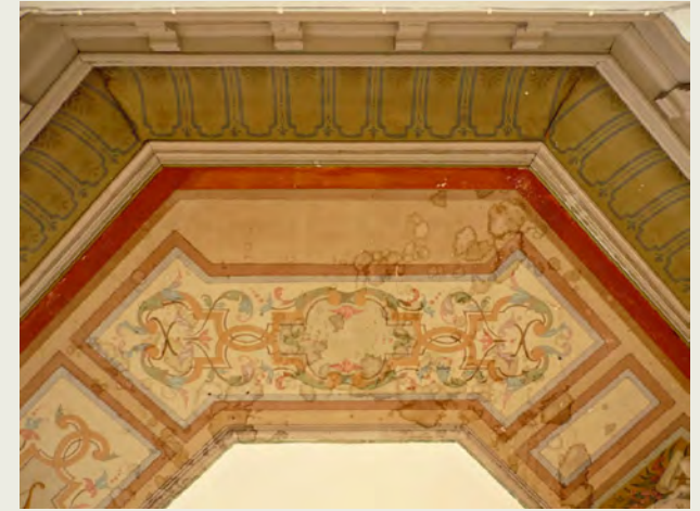
Huoneen 102 katon koristemaalauksissa on vesijalkiä.
