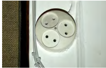
Pistorasia huoneen 205 seinällä.
