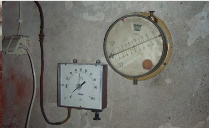
Öljysäiliön vanha ja uusi mittari.
