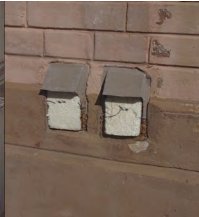
Talon ulkoseinältä löytyviä tukittuja ilmanottoaukkoja.
