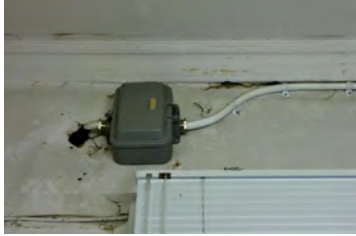
Sähkön sisäänotto rakennuksen etelänurkassa huoneessa 210.
