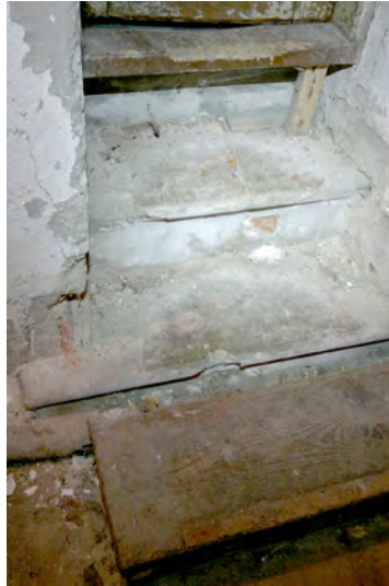
Pääportaasta kellariin johtavista porrasaskelmista kaksi ylintä on kivirakenteisia ja alin on puinen. Kiviaskelmat lienevät vuodelta 1889.
