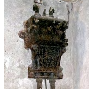
Pannuhuoneen seinällä on säilynyt vanha muuntaja.
