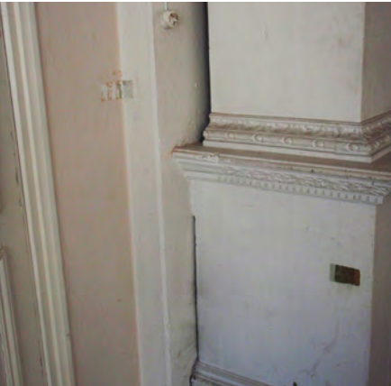
Huoneen 101 kakluunin takana on rako, josta raitisilma on noussut huoneeseen. (kts kuva 105 G.E.Asp s. 15)
