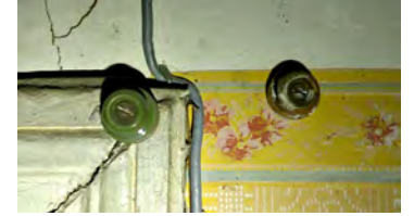
Erivärisiä, posliinisia sähkövetojen kiinnikkeitä tilassa 206.
