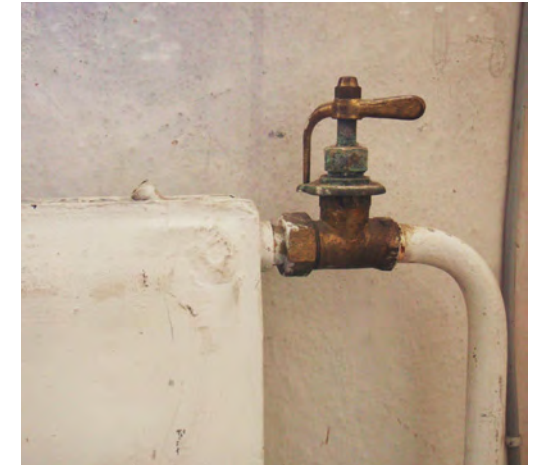
Puistokatu 4:n radiaattoreiden venttiili.
