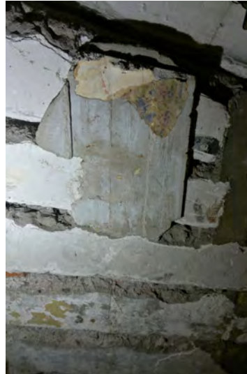
Pääportaan toisen juoksun alapintaa komerotilassa 116. Askelmien alapinnoissa on jäämiä rappauksesta ja pintakäsittelyistä. Juoksu lienee koottu Stenbäckin vuoden 1889 portaiden askelmista.
