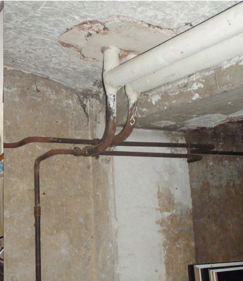
Lämmitysputkien läpivienti kellarista 1. kerrokseen (huoneesta 007 huoneeseen 101); ja lämmitysputkien haarauminen radiaattoreille huoneissa 007 ja 008.
