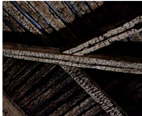
Hiiltynyttä rakennetta tilassa 315.
