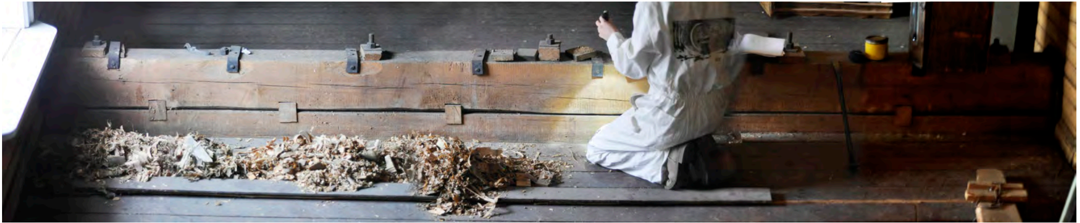
Kuva 1: Kiila-ansas huoneessa 309, avauskohta H.
