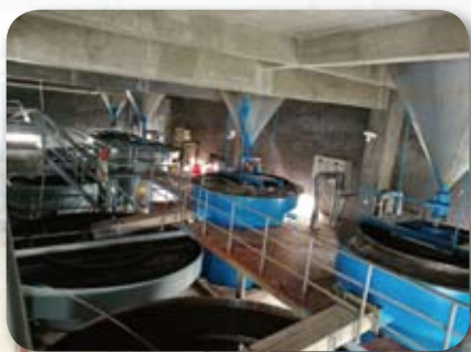
分机脱泥作业工业现场
