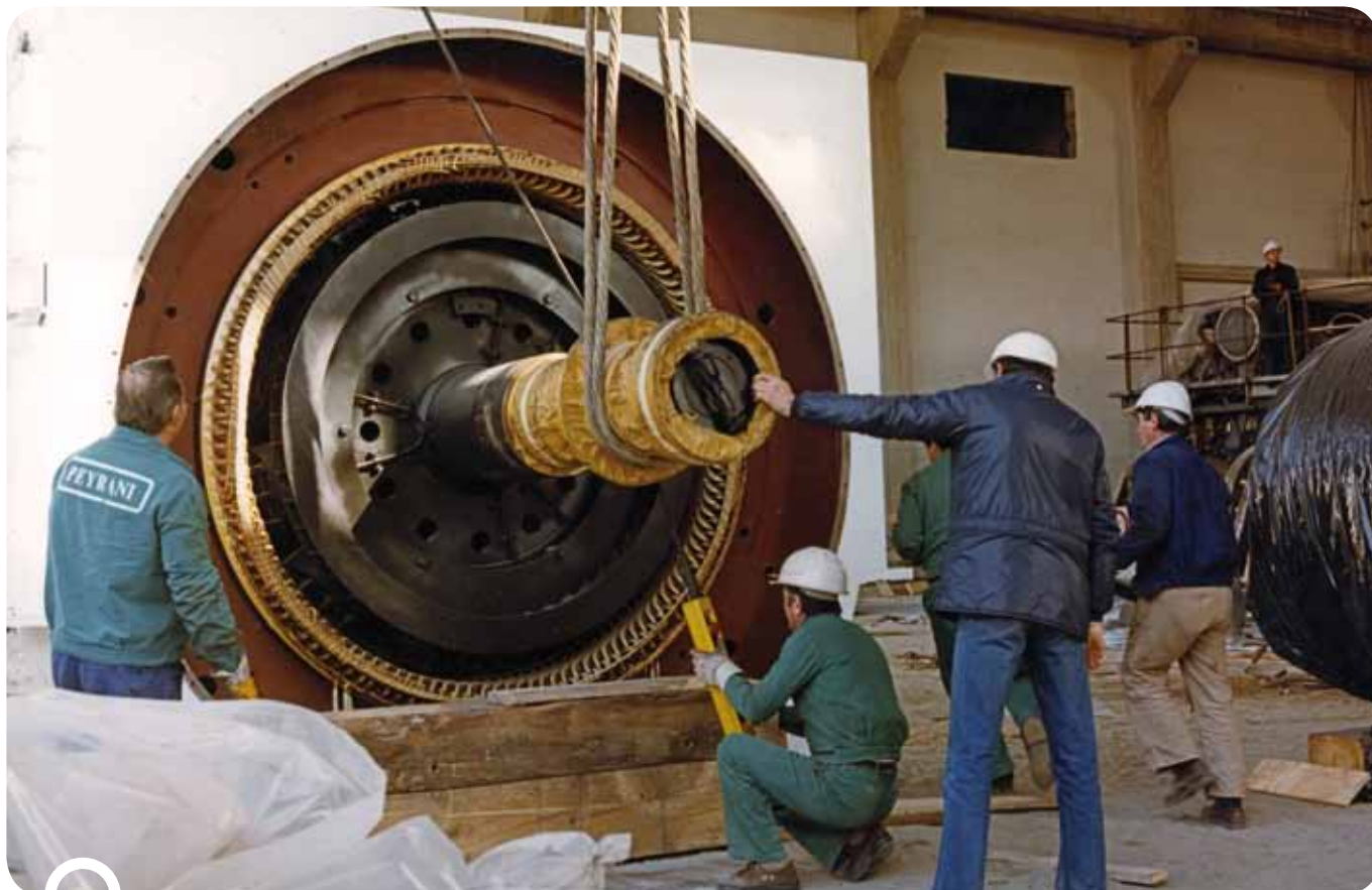
Centrale Le Vallette: montaggio alternatore di uno dei motori endotermici
