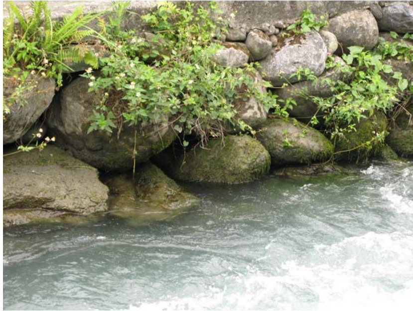
圖 98 卵石砌水圳護堤
