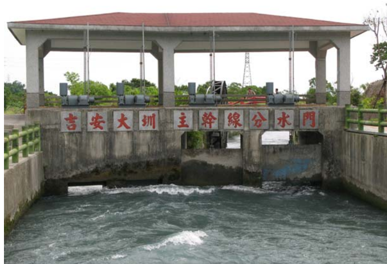
圖 101 水圳主幹線分水門
