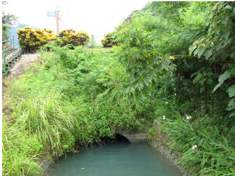
圖 94 題字「滾滾」集水井出水口
