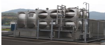
受水槽（貯水タンク）
