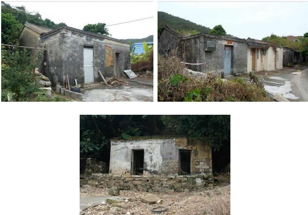
圖 226. 磡頭村以青磚及夯土建成的村屋（上）及破爛的村屋（下）
