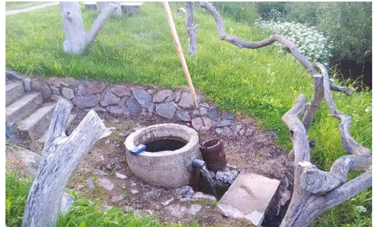
156 pav. Baltojo šaltinio ištaka pertvarkyta – vandeniui surinkti sumontuotas gelžbetonio rentinys, dirva sutvirtinta skelto akmenų grindiniu. Svirtis su kibiru – etnografinis akcentas, tinkantis senoviniam kaimo šuliniiui, o ne natūraliam karstiniam šaltiniui (Pasvalio r.)
