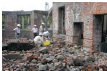
原爆ドームにおける煉瓦壁の調査 Investigation of the brick walls of the Hiroshima Peace Memorial (Genbaku Dome)
