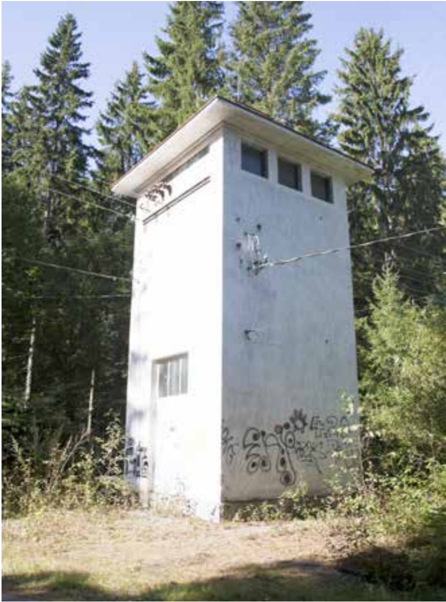
215F Nuppulinnan muuntamotorni IMG_8142.jpg
