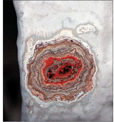
Afb. 2: Korenbeurs, detail gietijzeren console met duidelijk zichtbaar de verschillende gekleurde lagen verf. Foto: L. Muller, Zuidhorn.
