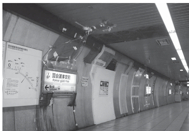
写真-3 外観悪化状況
