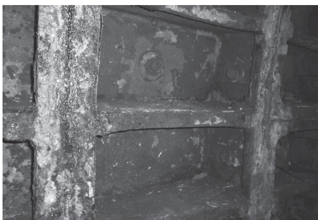
写真-2 セグメント発錆状況
