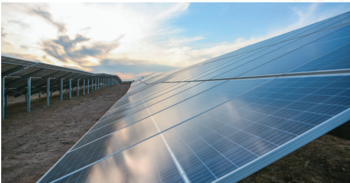
50 MW, Andévalo, Spain.
