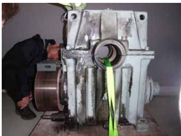
ギアボックスの外側には、オイル汚れ及びブレーキライニングの摩耗粉と思われる黒い粉が付着していた。
