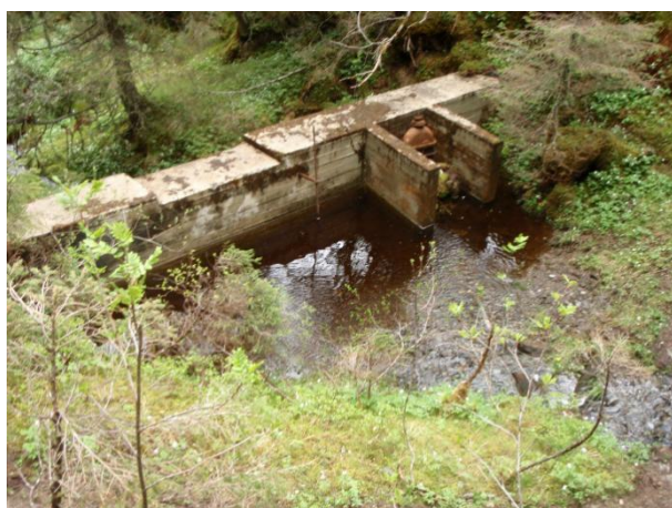
Figur 29. Inntaksdam med ventil i Svarttjønnbekken. (Harald Norem)
