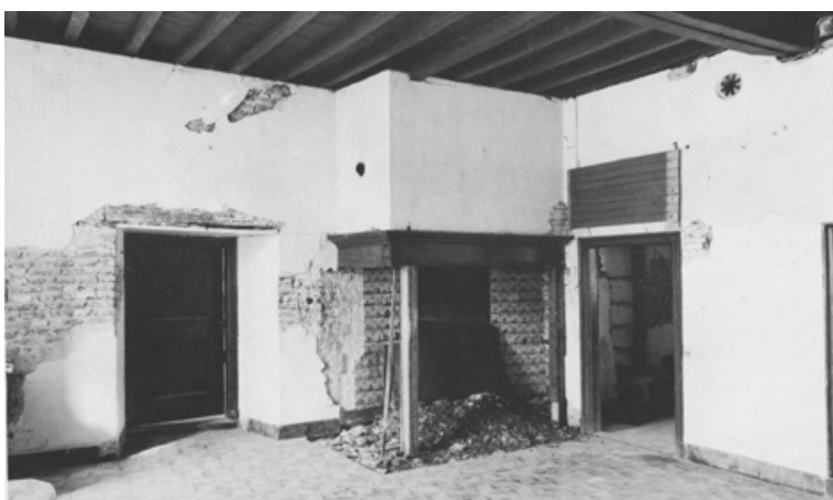
Afb. 117. Huis Doddendaal. De keuken tijdens de restauratie. Sporen van de oorspronkelijke haardplaats (opn. 1974).
