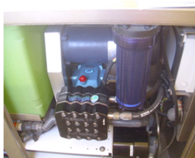
Figure 53: Filtre à charbon actif et module spirale
