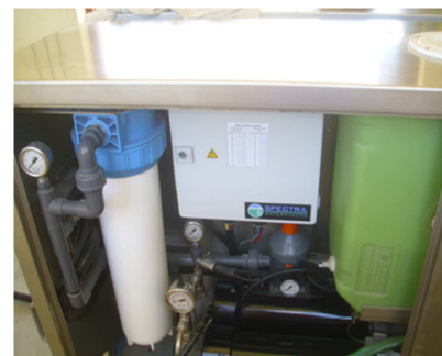
Figure 52: Filtre 5µm et réservoir du Back flush
